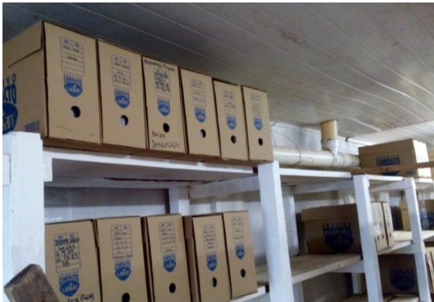
Figura 5 – Estantes de madeira dispostas embaixo de tubulações
