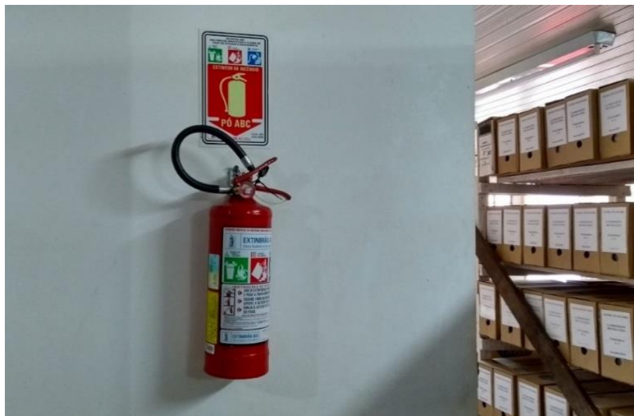
Figura 9 - Extintor portátil de incêndios do arquivo
