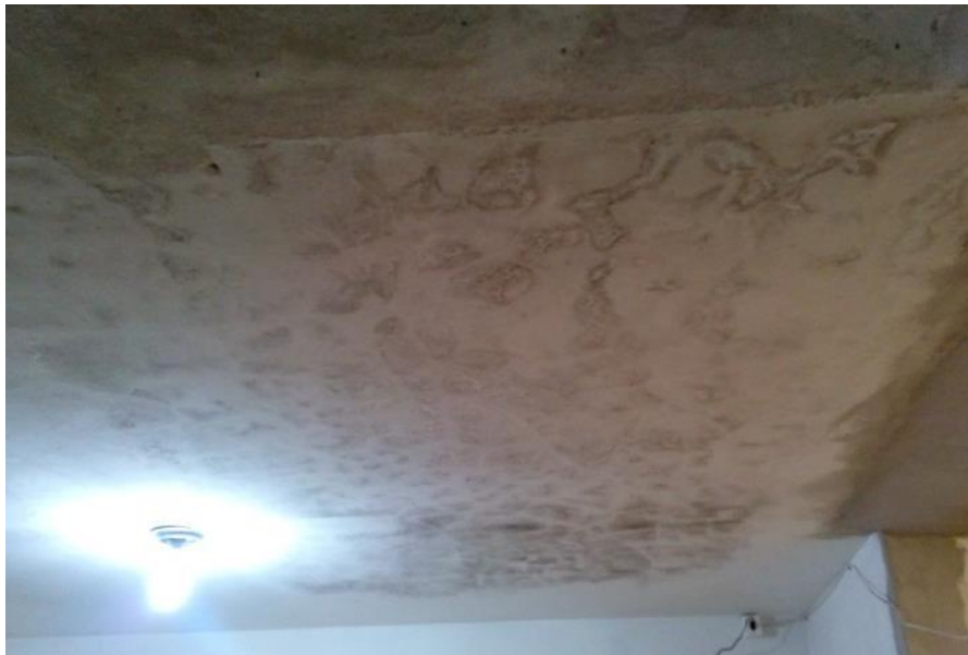
Figura 7 - Forro de alvenaria mofado, antes da pintura.
