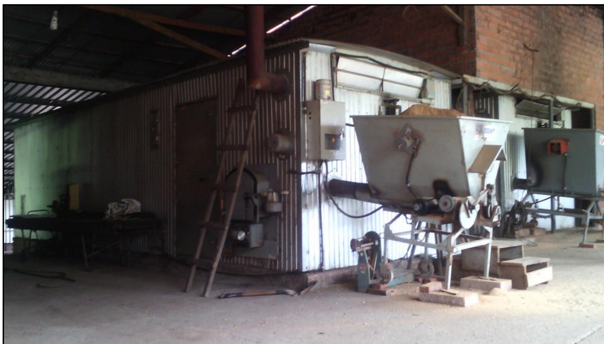
Figura 4 - Unidades de cura de tabaco de ar forçado adaptadas com alimentadores automatizados
