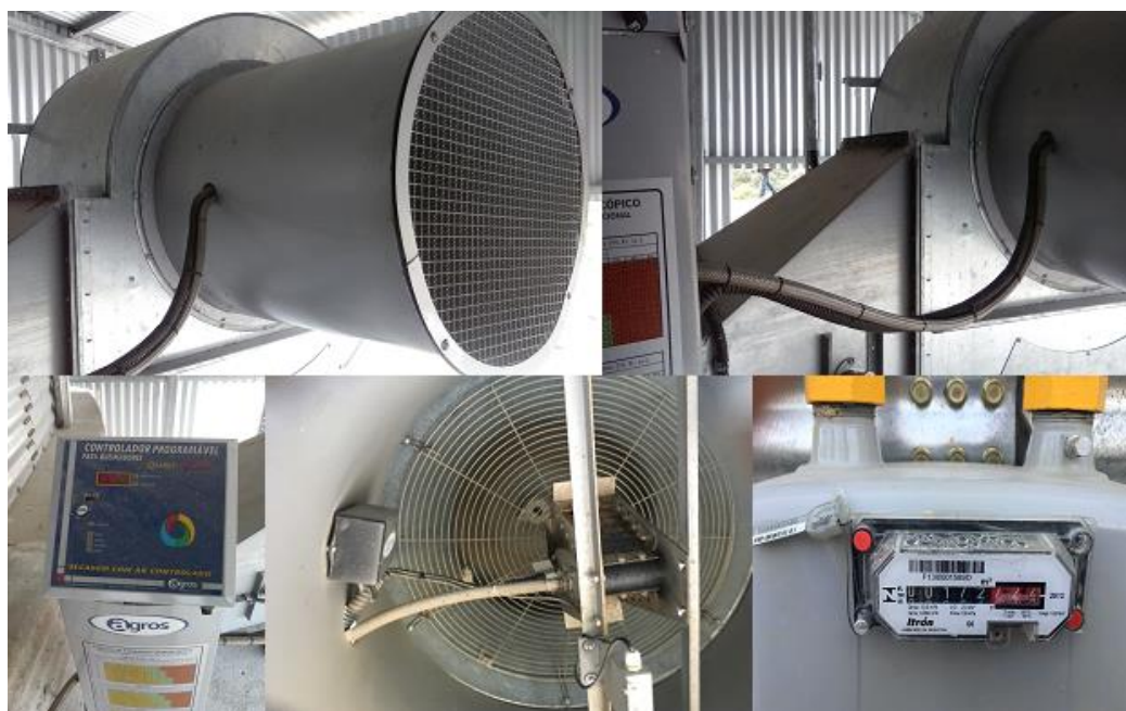
Figura 6 - Exaustores, queimadores a gás, controladores e sistema de monitoramento.
