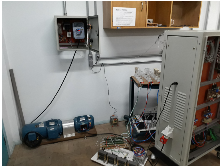
Figura 6.2 – Inversor de Frequência e conjunto máquina primária/gerador de indução
