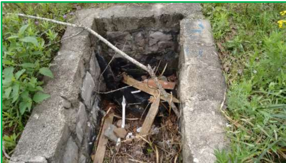
Figura 11 - Fotografia de bueiro que deveria servir para escoar a água pluvial, sem proteção e atulhado de resíduos.
