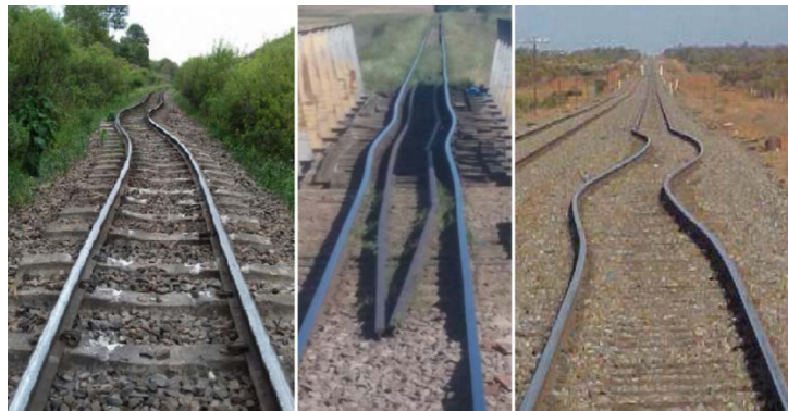
Figura 2.5 – Desalinhamento de trilhos.
