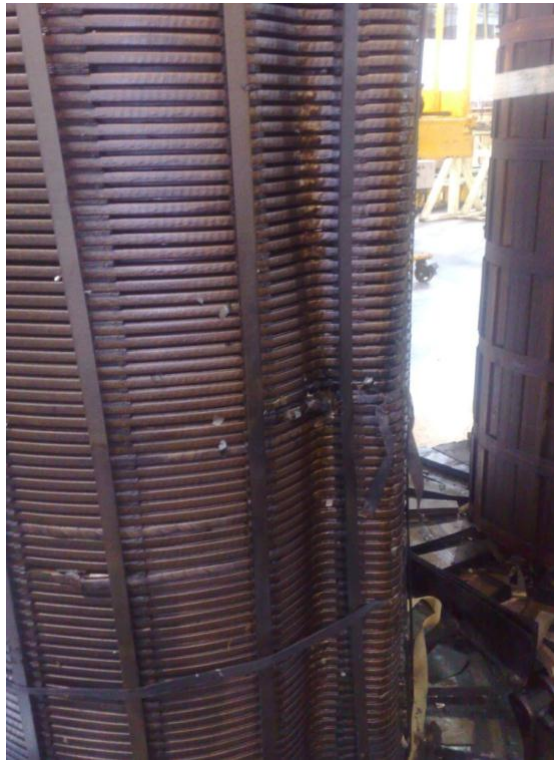
Figura 4 – Foto do Enroalemtno de Baixa Tensão com Defeito
