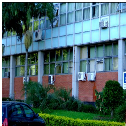
Figura 41 - Detalhe fachada Leste: splits
