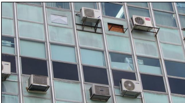
Figura 40 - Detalhe fachada Leste: remendo chapas
