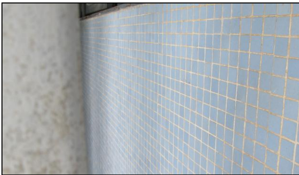
Figura 30 - Pastilhas originais, peitoril fachada Oeste
