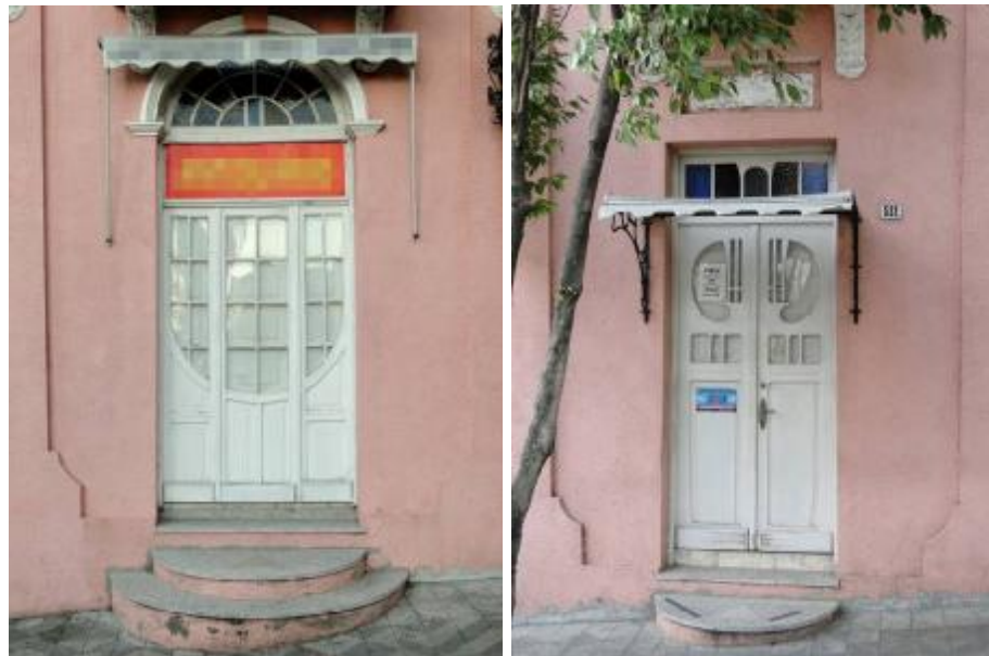
Figura 101 – Portas do andar térreo: uma das portas laterais (esquerda) e porta central (direita)
