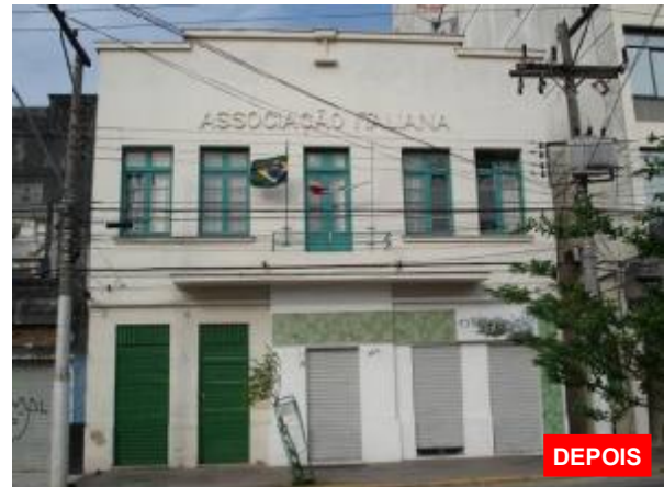
Figura 06 – Descaracterização de imóvel, retirada de portas e esquadrias, gerando perda parcial na simetria compositiva Fonte - Arquivo do autor, 2010
