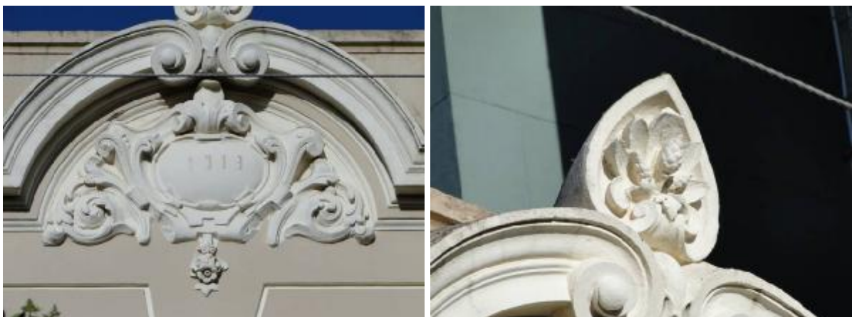
Figura 97 – Cartela, contendo o ano de construção da casa (1913), encimada pela cornija (esquerda) e acrotério em palmeira no alto do conjunto (direita)
