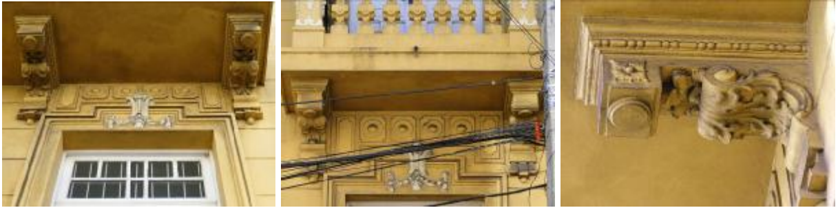
Figura 58 – Sobrevergas das janelas do térreo e apoio das mãos-francesas
