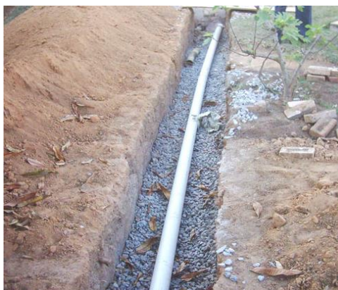
Figura 7 – Tubulação PVC por onde o efluente é distribuído na vala
