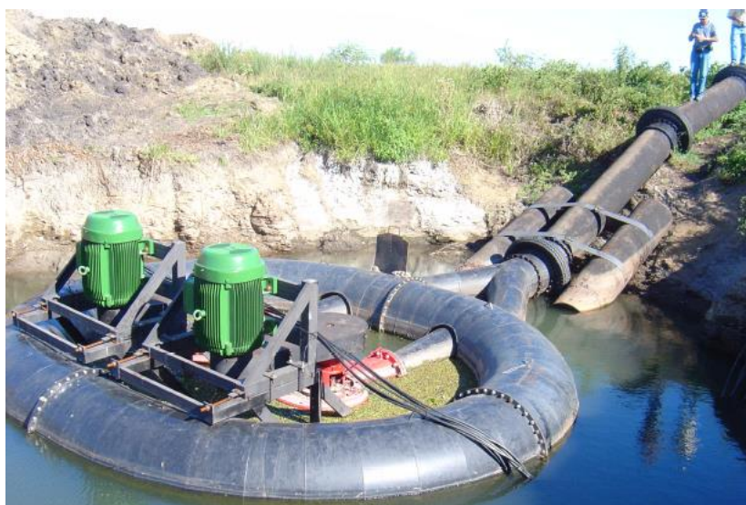
Figura 2.3 – Bombas de irrigação – Início do levante para lavouras de arroz
