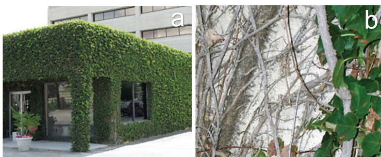
Figura 7 – Hera-inglesa: (a) fachada; (b) fixação das raízes secundárias na parede
