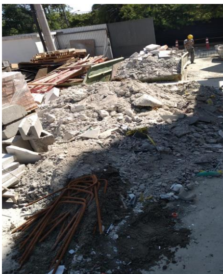
Figura 35: Caçambas de entulho lotadas e resíduos nos arredores
