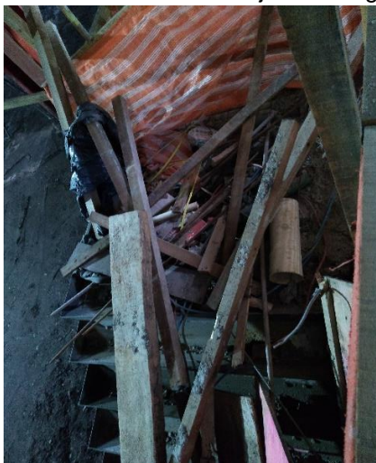
Figura 36: Canteiro de obras sujo e desorganizado
