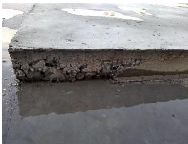
Figura 45: Vazios no concreto em base de equipamentos
