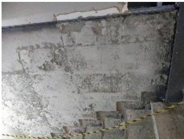
Figura 44: Remoção de cerâmica mal executada
