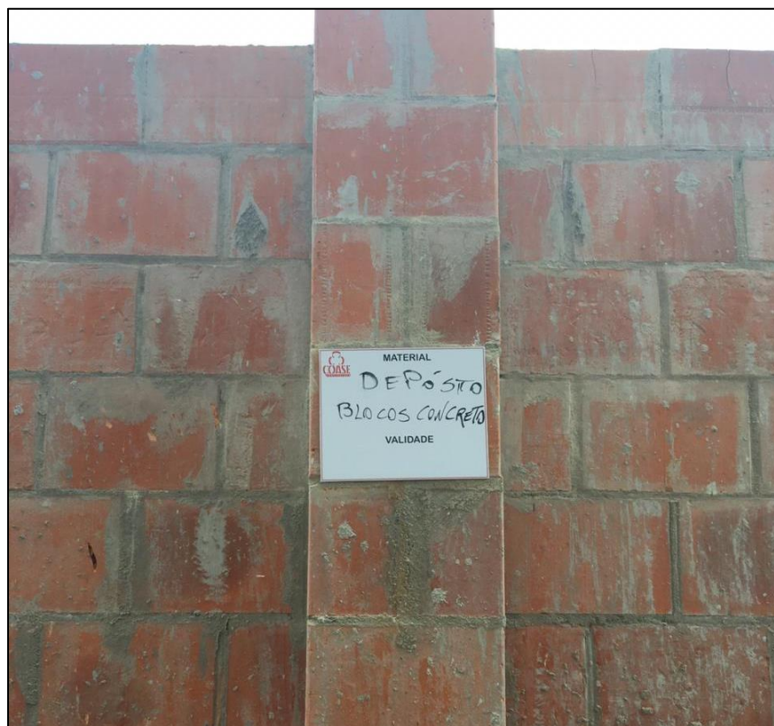
Figura 23 – Local para depósito de blocos de concreto próximo às bases do muro.
