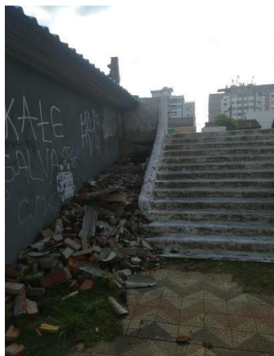
Figura 9.2 — Imagem da escada com escombros na Praça Saturnino de Brito
