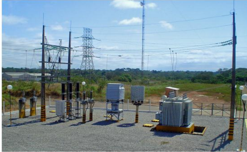
Figura 3.16 – Subestação supridora do PRE, em Samuel
