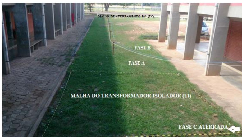
Figura 5.40 – Saída do circuito do transformador isolador, malha do (TI) , fases aéreas A e B e a terceira fase C conectada ao solo. Ao fundo malha de aterramento do (TC)
