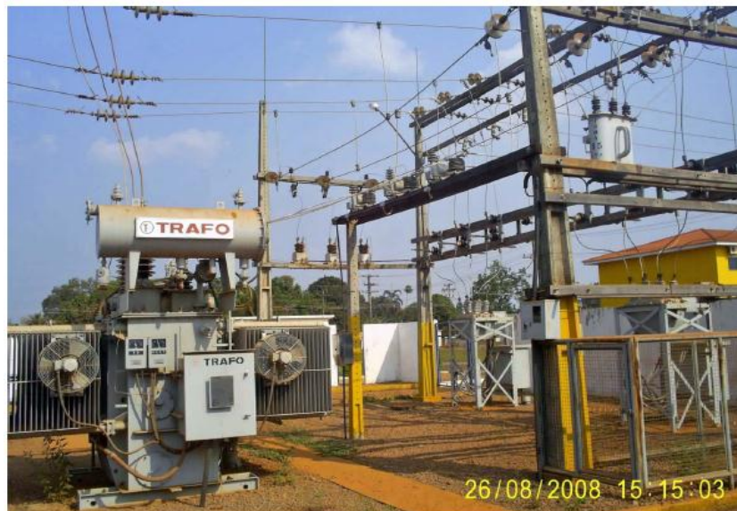
Figura 3.17 – Subestação distribuidora do PRE, em Itapuã do Oeste
