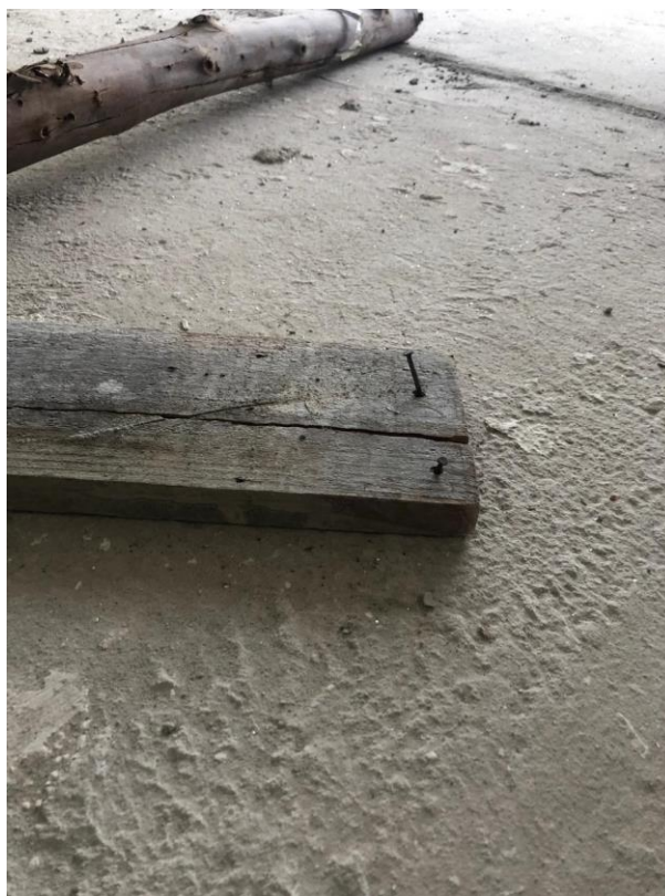
Figura 19 – Madeira com presença de pregos no canteiro de obras.
