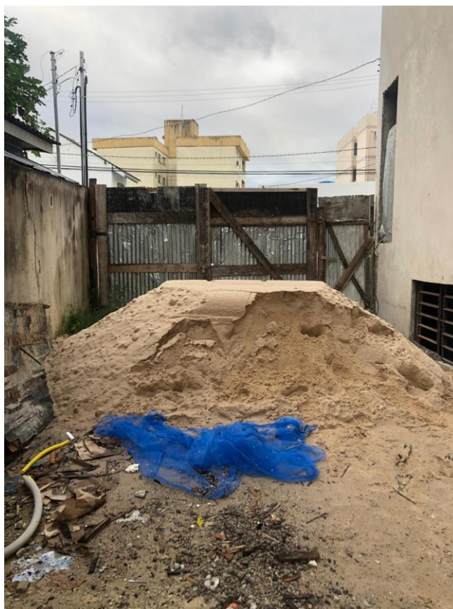
Figura 13 – Armazenamento inadequado da areia no canteiro de obras.
