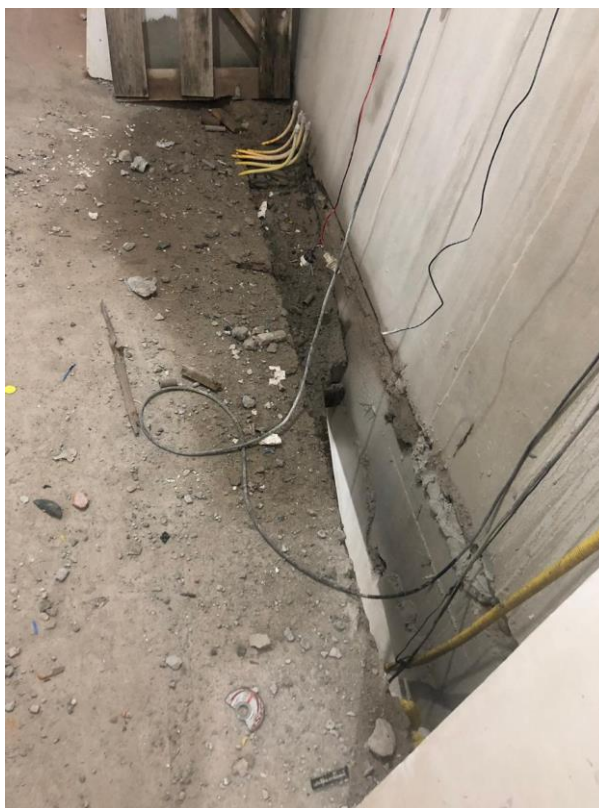
Figura 20 – Shaft sem proteção adequada no canteiro de obras.
