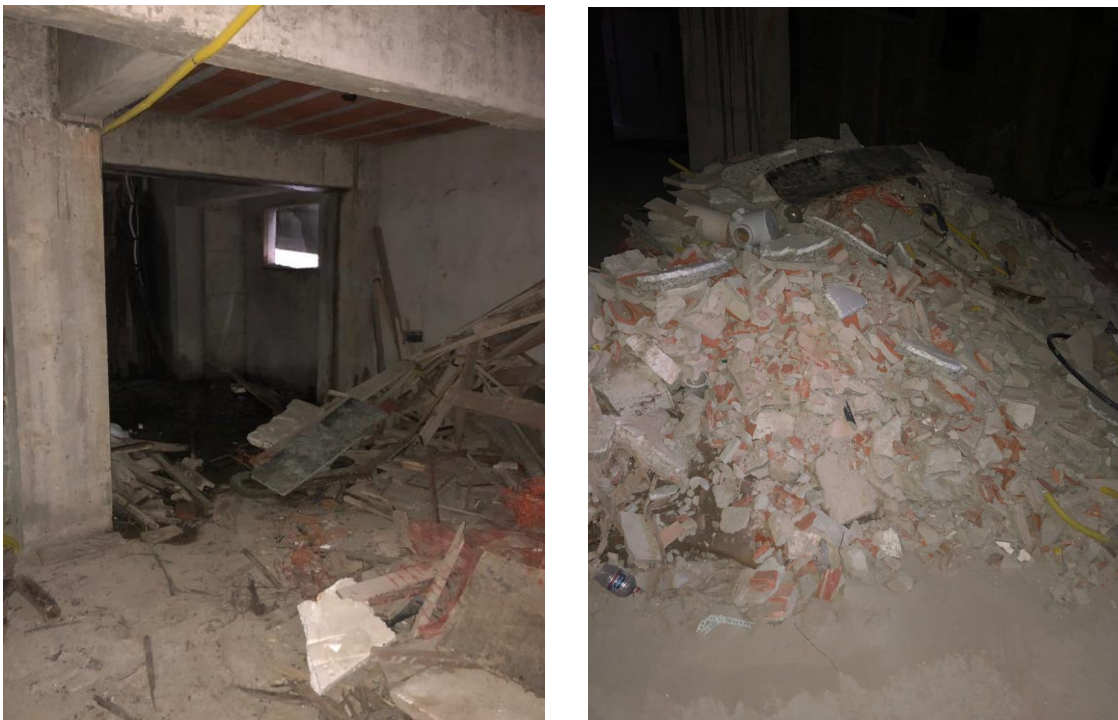
Figura 14 – Acúmulo indevido de entulho no canteiro de obras.
