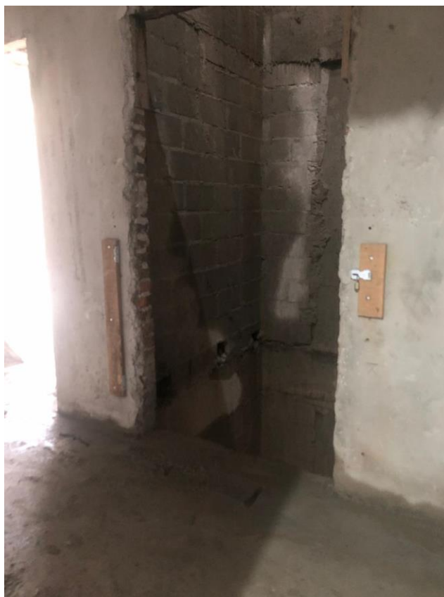
Figura 18 – Poço do elevador sem proteção adequada no canteiro de obras.
