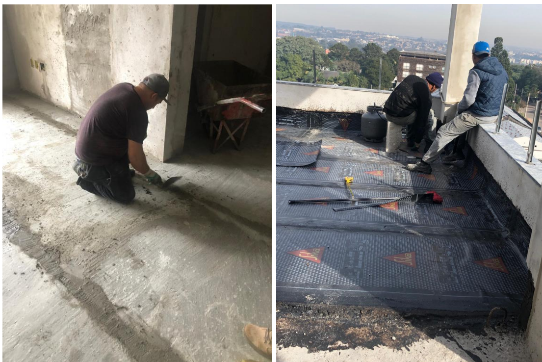
Figura 17 – Ausência dos EPIs e ausência de proteção periférica.
