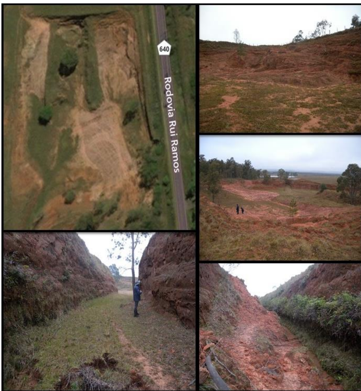
Figura 19 - Voçoroca localizada na estrada de acesso ao município de Cacequi.
