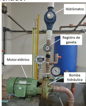
Figura 4 - Conjunto motobomba e peças especiais presentes no sistema de bombeamento de circuito fechado.
