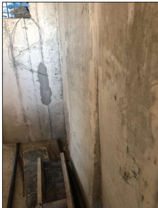
Figura 20 - Deformação da parede ocasionada pela Abertura da Forma no Empreendimento em estudo na cidade de Santa Maria – RS.
