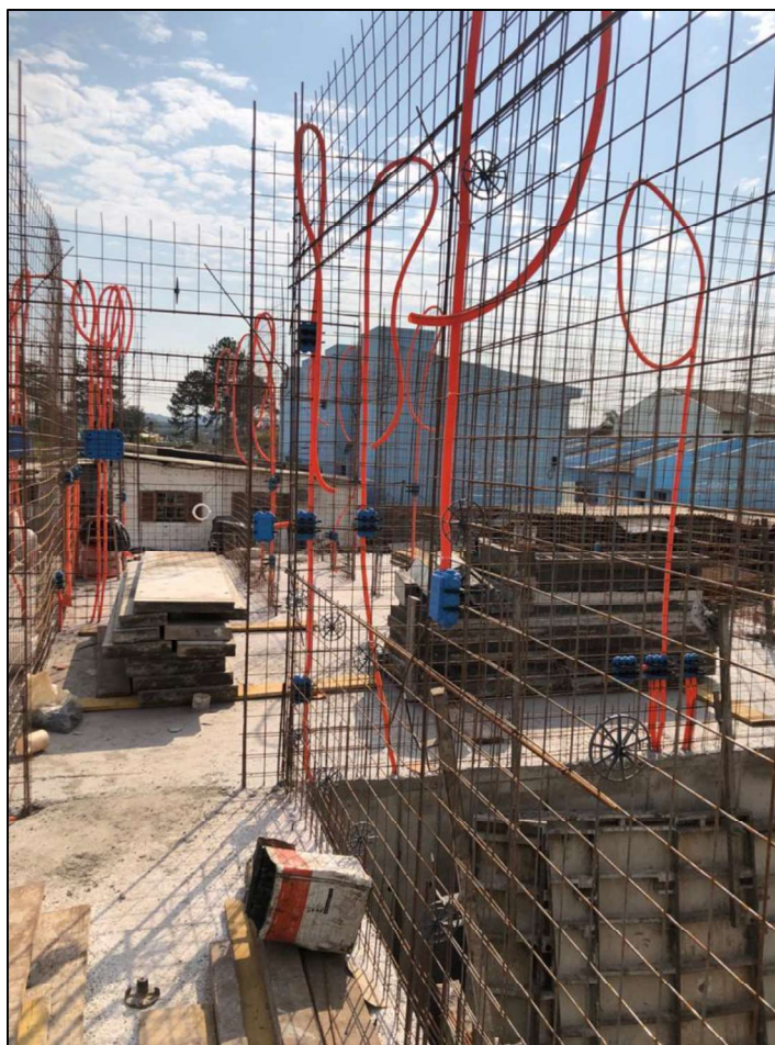
Figura 12 - Sistema de Armaduras e Instalações Embutidas para Paredes de Concreto Moldadas in loco em uma obra em Santa Maria – RS.
