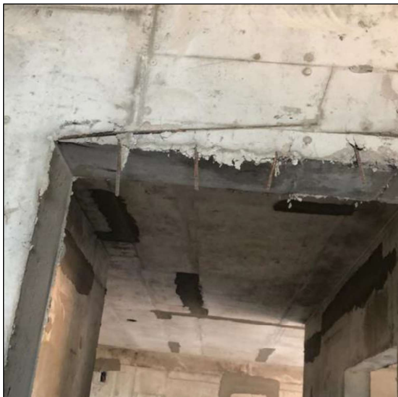
Figura 35 - Armadura Exposta no Apartamento 202E.
