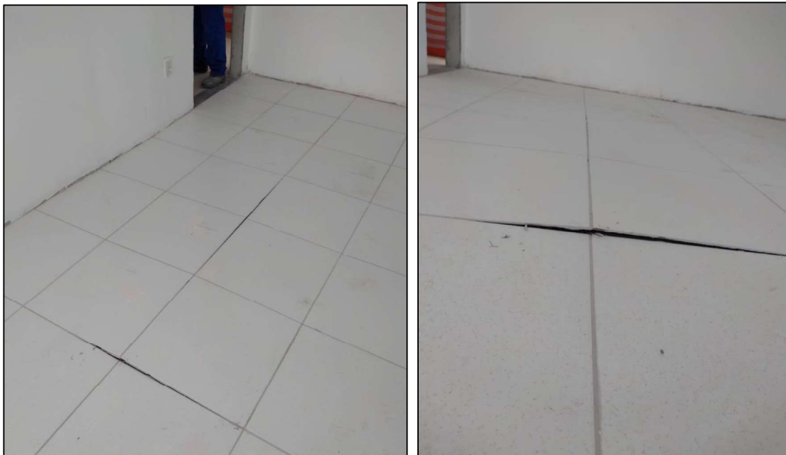
Figura 318 (a e b) - Desplacamento Cerâmico no Apartamento 702B.
