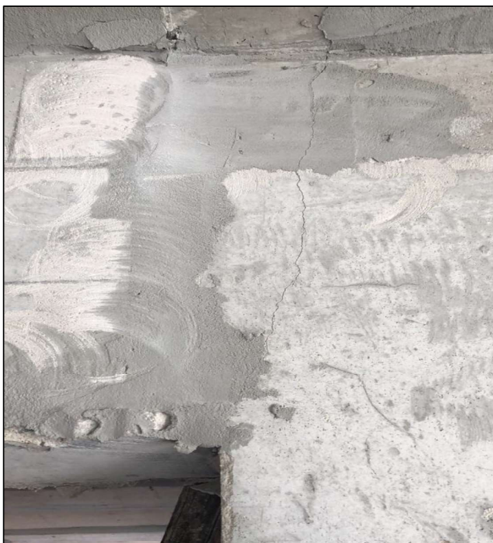
Figura 18 - Aparecimento de Fissura no vão de Entrada para o Apartamento do Residencial Hera – Santa Maria - RS.
