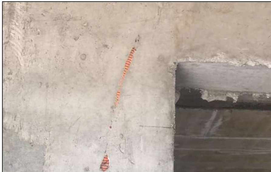
Figura 36 - Tubulação Aparente no Apartamento 104D.
