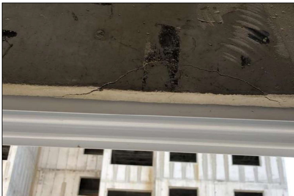
Figura 37 - Defeito de Contramarco localizado no Apartamento 101E.
