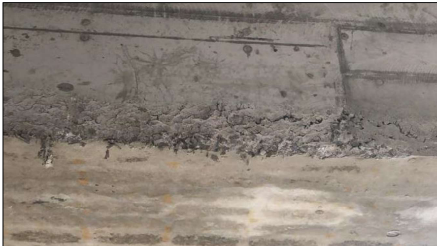
Figura 39 - Segregação do Concreto localizada no Apartamento 104D.
