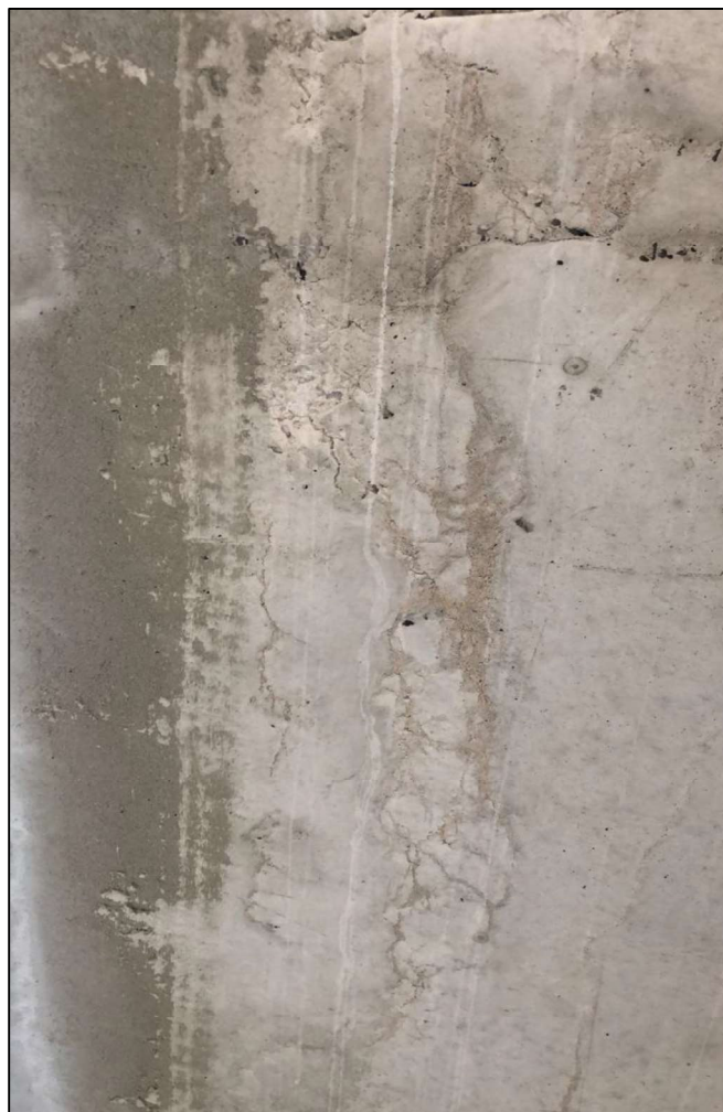
Figura 40- Segregação do Concreto localizado no Apartamento 503D.
