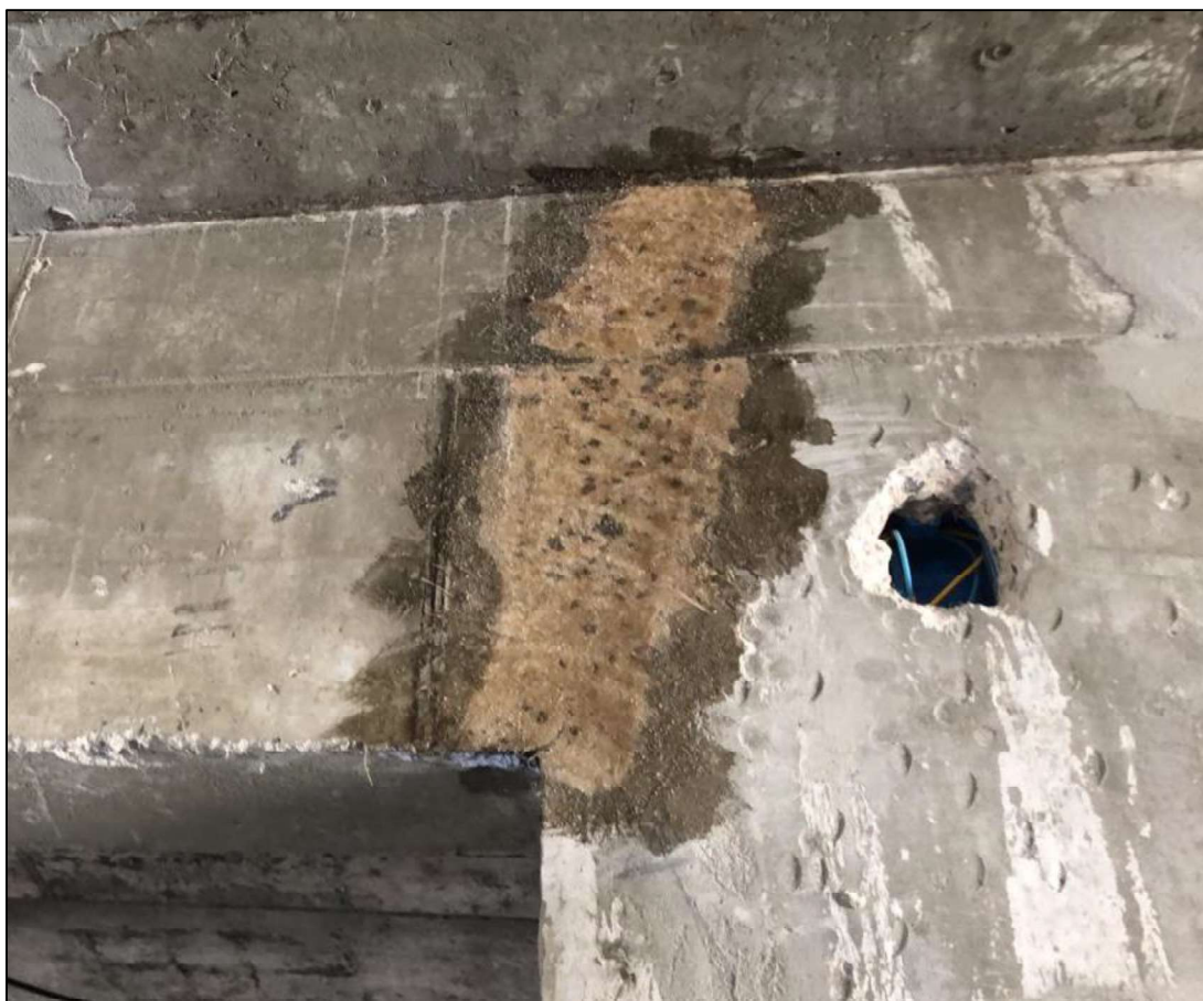
Figura 54 - Tratamento para as Fissuras de 45° e 90° em Vãos de Esquadrias.
