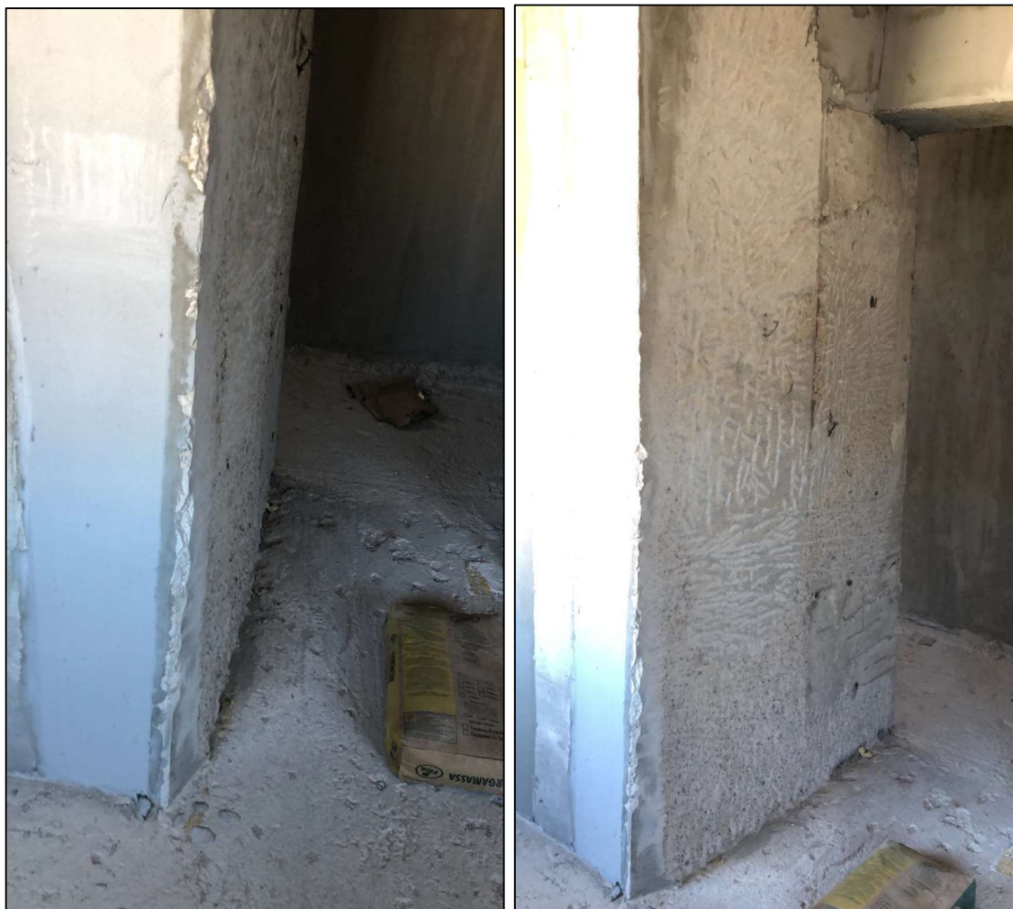
Figura 32 (a e b) - Defeitos Geométricos ocasionado pela Abertura entre Placas no Apartamento 104E – PDC.
