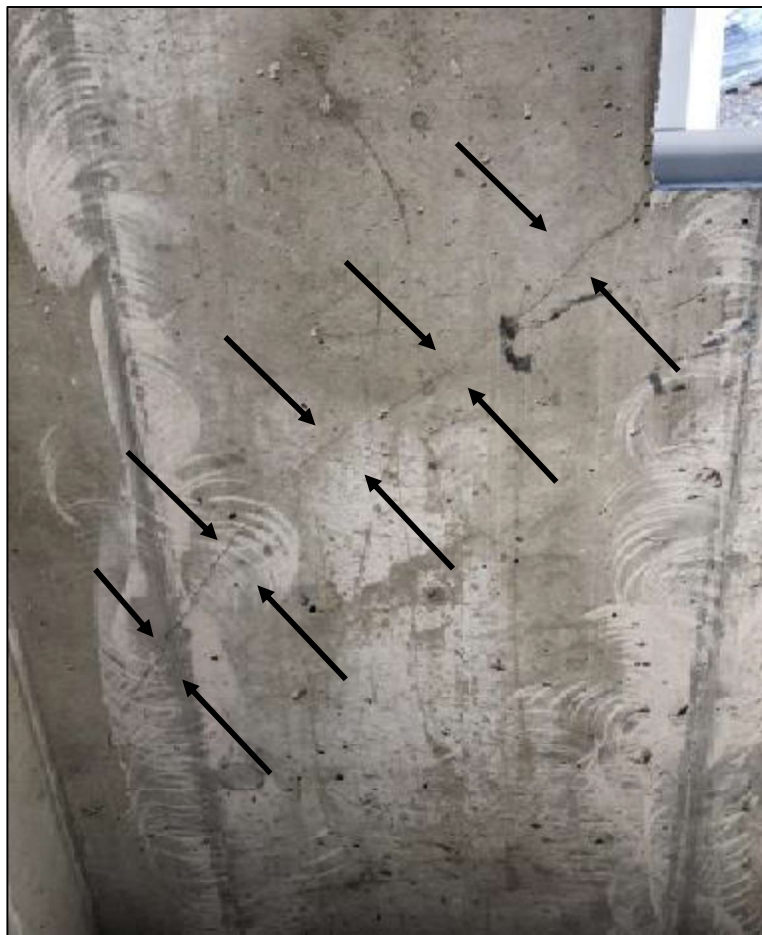
Figura 26 - Fissura em 45° no Vão de Janela.
