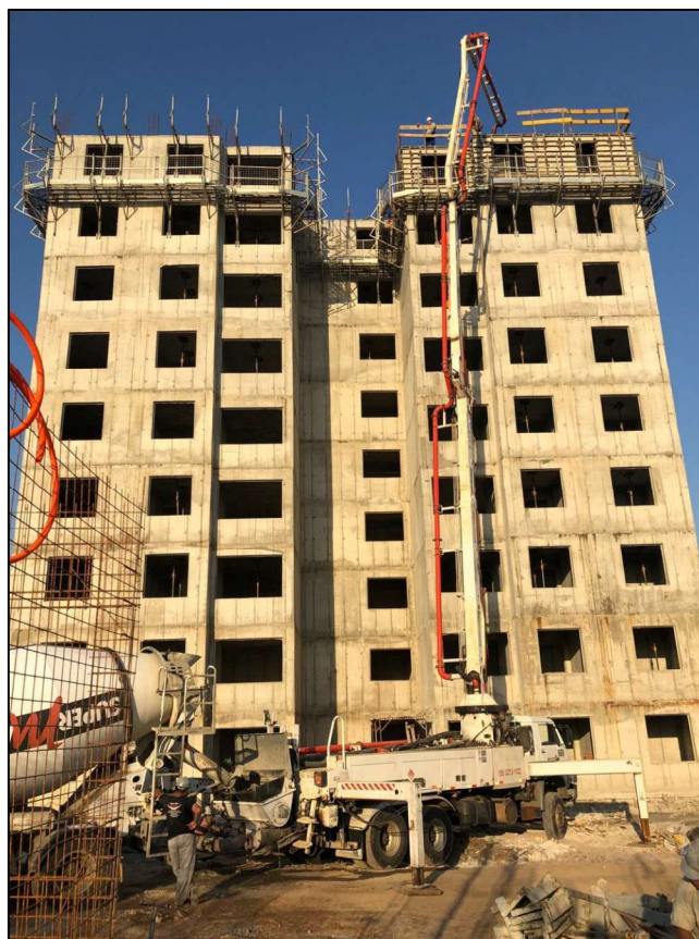
Figura 14 - Lançamento do Concreto para o 9º andar do Empreendimento Residencial Hera – Santa Maria - RS.
