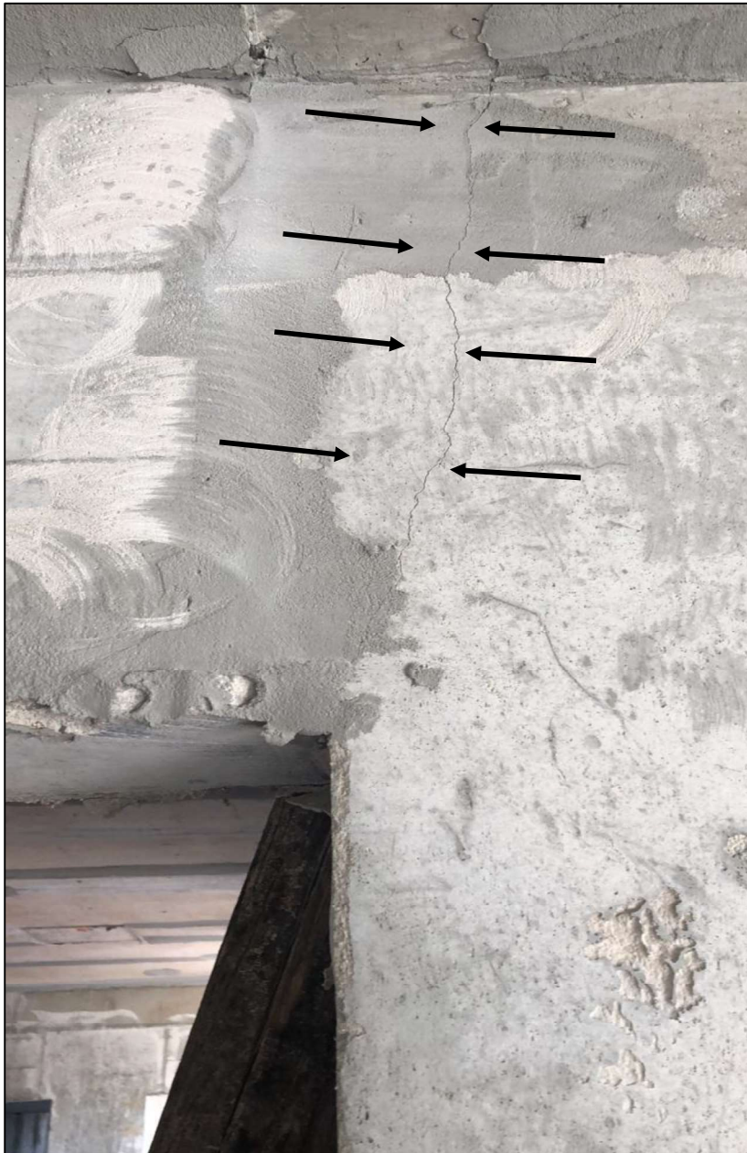
Figura 25 - Fissura em 90° no Vão da Porta de Entrada.
