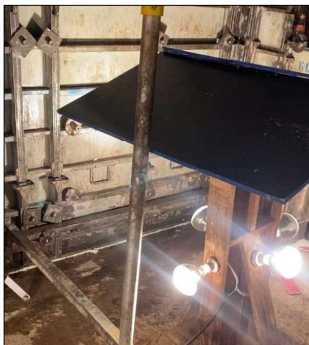
Figura 61 - Aplicação de Lâmpadas de Aquecimento no auxílio da Cura do Concreto em uma obra em Santa Maria – RS.
