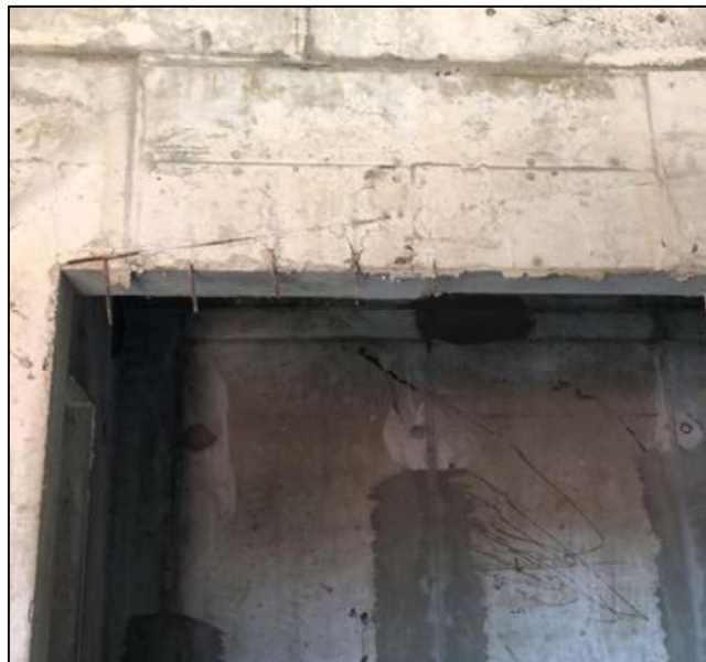
Figura 21 - Deslocamento da Armadura abaixo do vão da Porta de Entrada.
