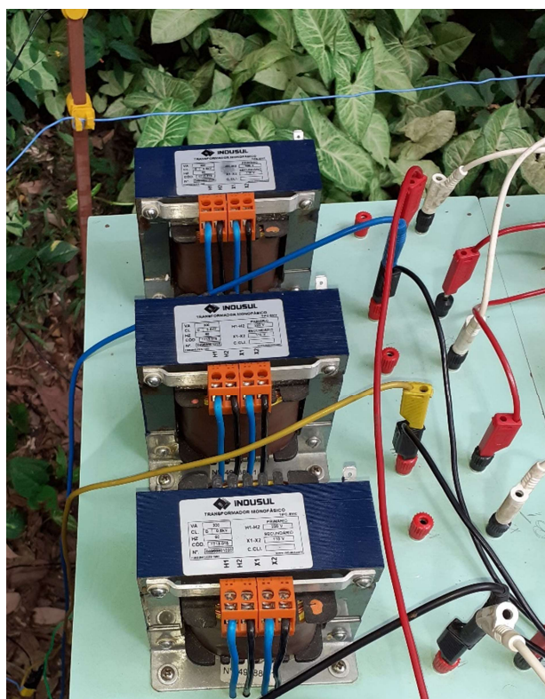
Figura 19: Grupo de transformadores monofásicos, pelo lado do consumidor
