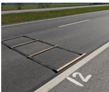
Figura 89 - Malha utilizada na execução de levantamento de área trincada
