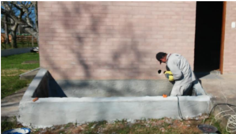
Figura 3.18: Execução de abertura dos buracos para entrada de ar quente no dormitório.
