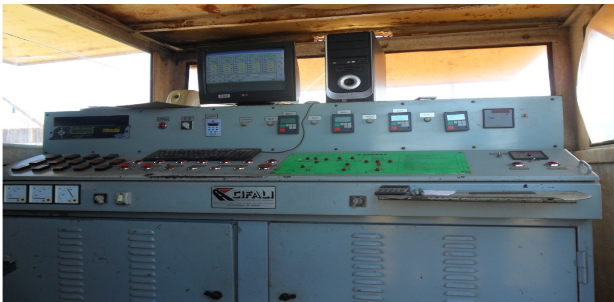
Figura 3 - Cabine de Comando
