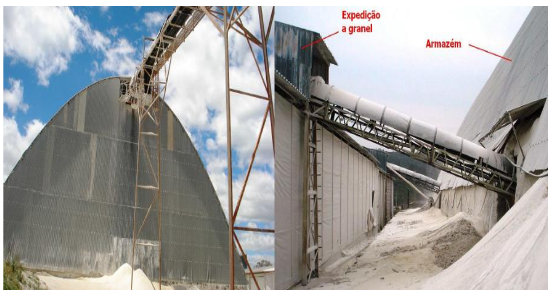
Figura 11 - Silo de armazenagem a granel e transporte até o carregamento.
