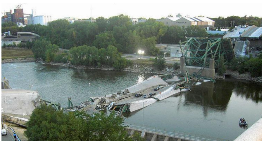
Figura 2.1 – Imagem aérea após o colapso da ponte da rodovia I-35W sobre o rio Mississippi em Minneapolis.
