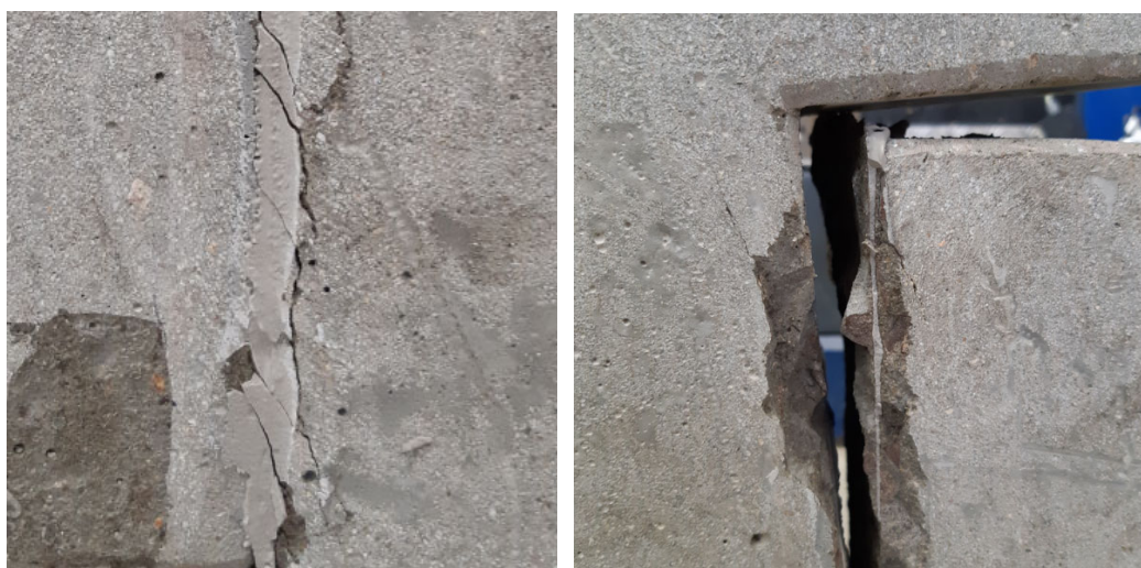
Figura 7.3 – Evolução das fissuras e modo de ruptura para a junta plana com epóxi JCE-C-2.
