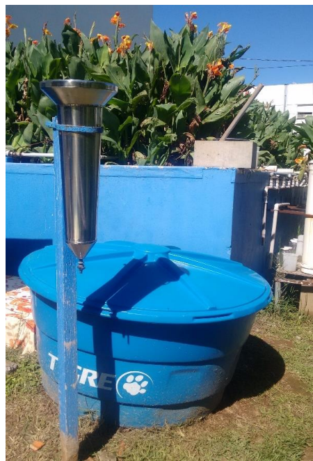
Figura 14 - Pluviômetro instalado na ETE experimental para monitoramento de precipitação incidente
