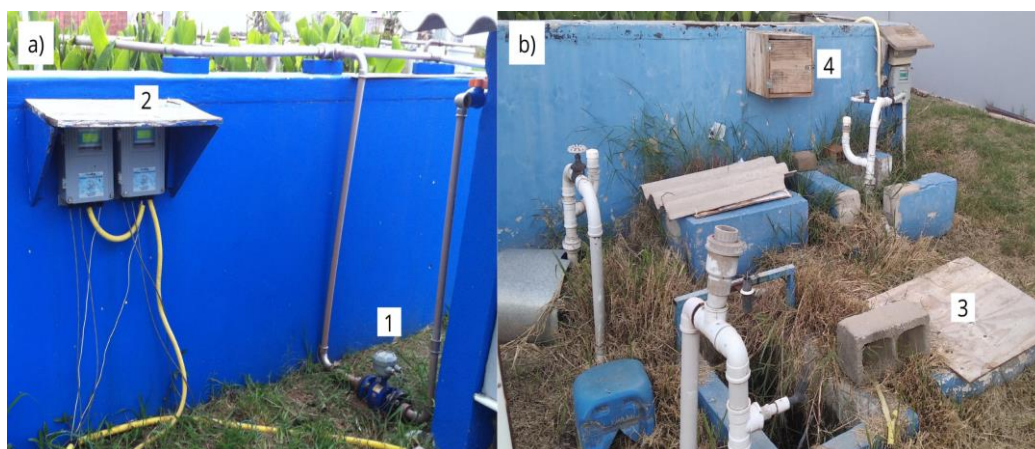
Figura 13 - Medidores de vazão do WCV-FS. a) Medidor eletromagnético da vazão afluyente. b) Sensor ultrassônico medidor da vazão efluente
