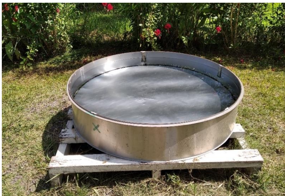
Figura 23 - Tanque classe A instalado próximo ao WCV-FS
