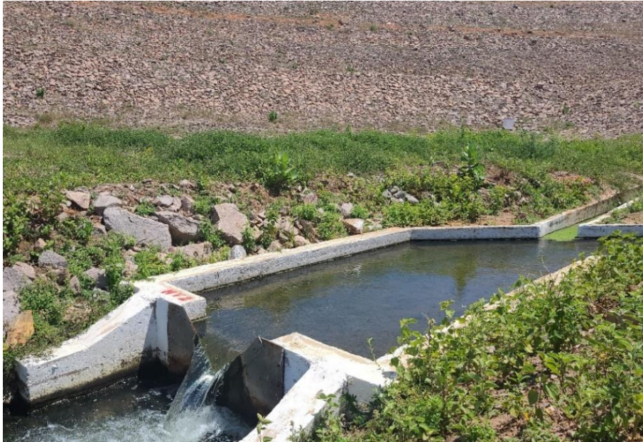
Figura 13 – Medidor de vazão de percolação na Barragem de Porcos, Brejo Santo-CE
