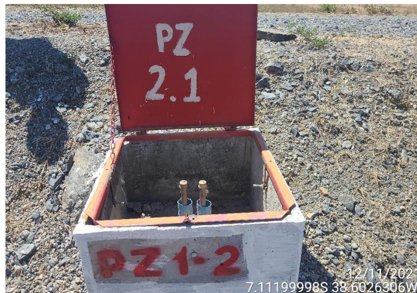
Figura 18 – Caixa de proteção de Piezômetros tipo Casagrande modificado de tubo aberto
