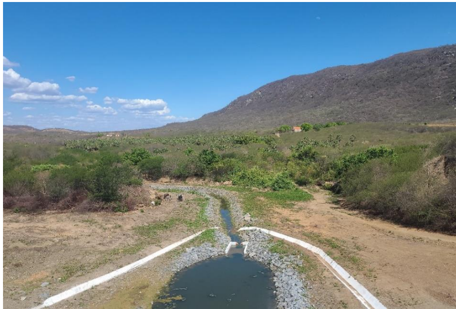
Figura 12 – Medidor de vazão de percolação na Barragem Morros, São José de Piranhas-PB
