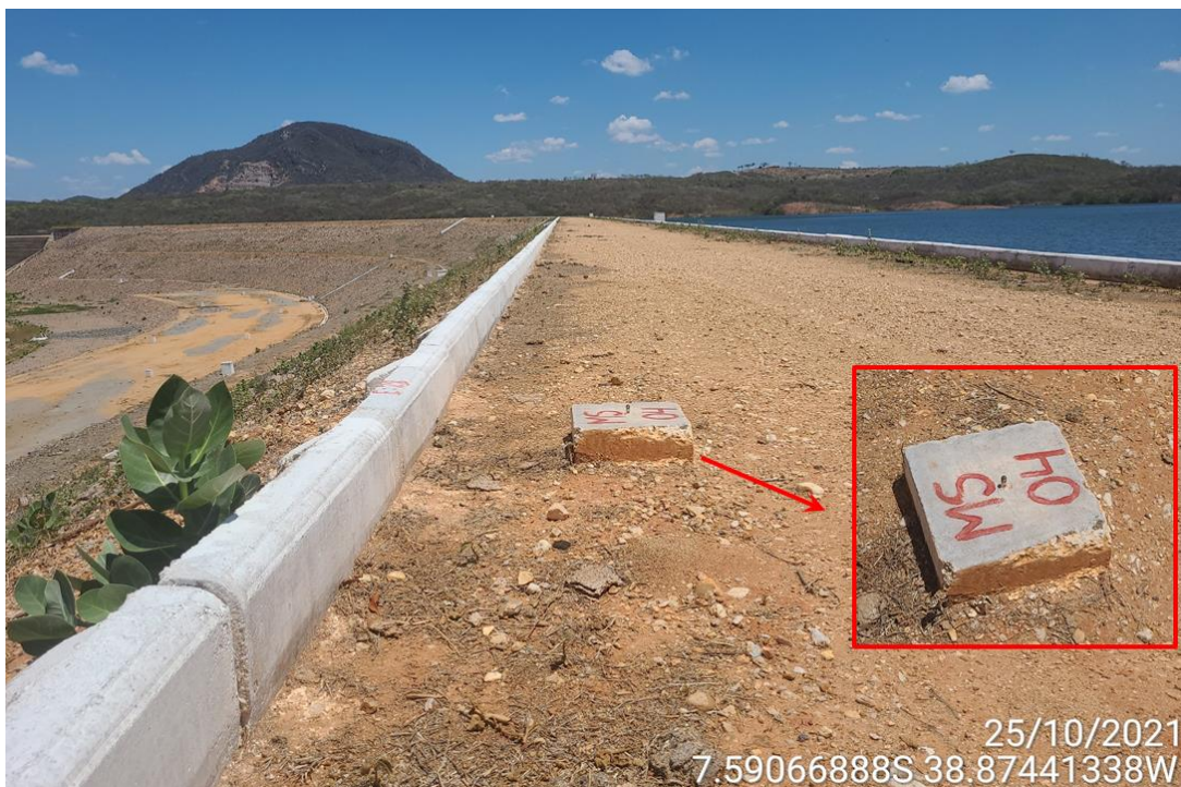
Figura 25 – Marco de deslocamento superficial na crista e demais instrumentos a jusante na Barragem de Porcos, em Brejo Santo-CE
