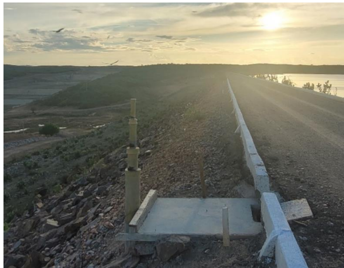
Figura 23 – Medidor de recalque telescópico na Barragem de Milagres, Salgueiro-PE.
