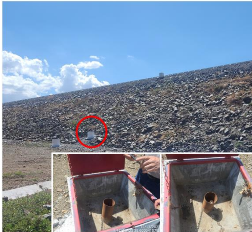
Figura 15 – Medidor de nível d'água da Barragem Morros, em São José de Piranhas-PB
