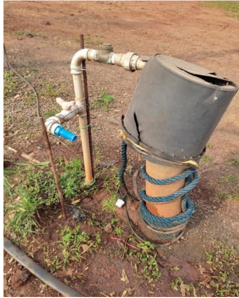
Figura 6 - Poço de captação da água (Ponto 1).
