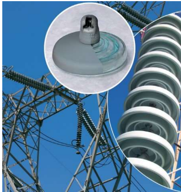
Figura 3.15 – Isoladores Sedicoat em operação
