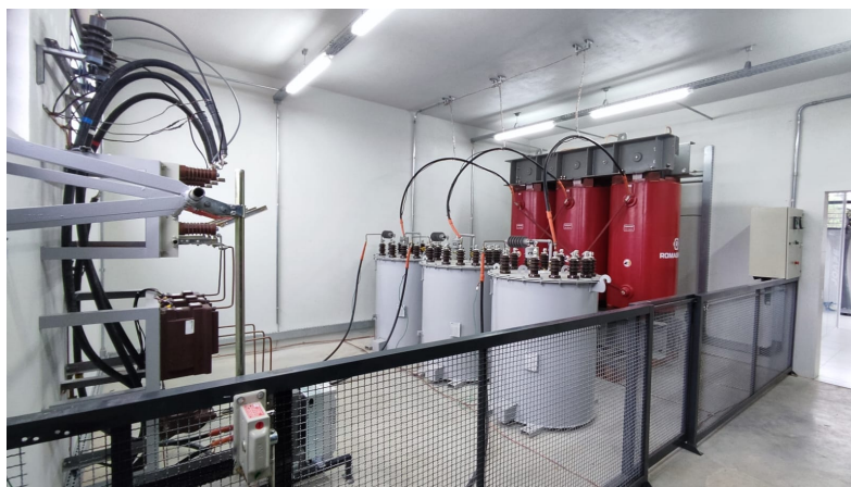
(b) Sala de máquinas com entrada de energia ao fundo.
