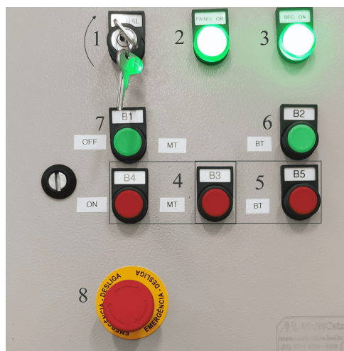
Figura 3.20 – Quadro de comando da sala de controle.
