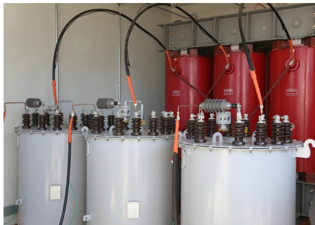
Figura 3.12 – Reatores monofásicos conectados ao transformador de potência.
