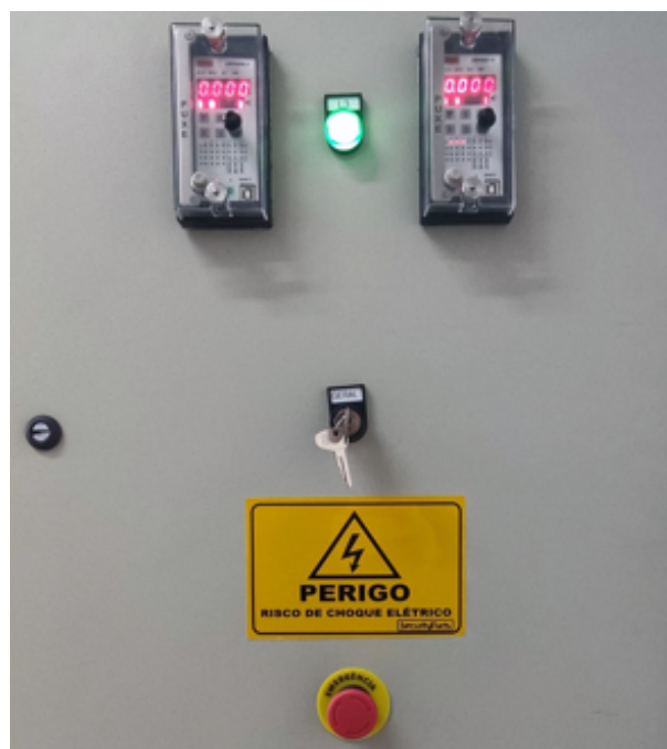
Figura 3.16 – Quadro de comando da sala de máquinas.
