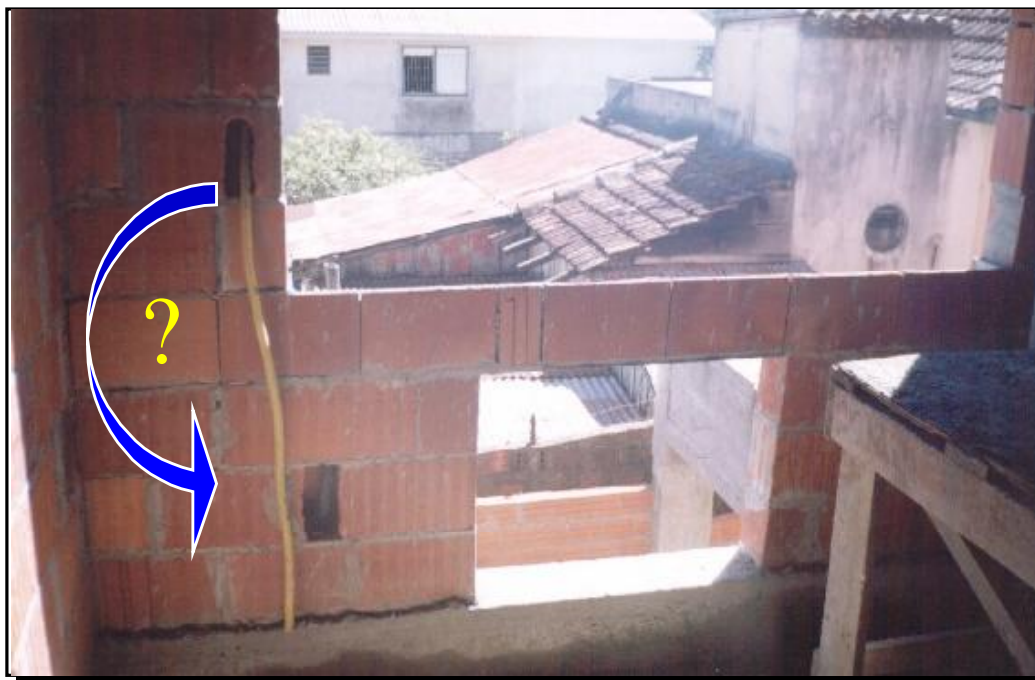
FIGURA 4.13 – Eletroduto para tomada do condicionador de ar sem passagem pela contra-verga da janela.
