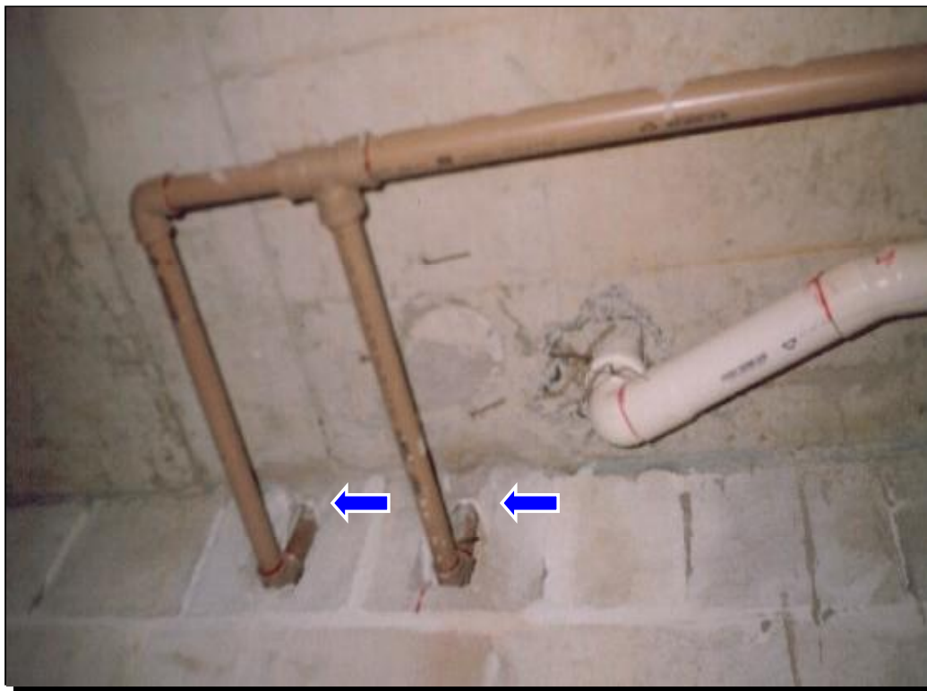
FIGURA 5.2 – Tubulação hidrossanitária passando livremente através da cinta.
