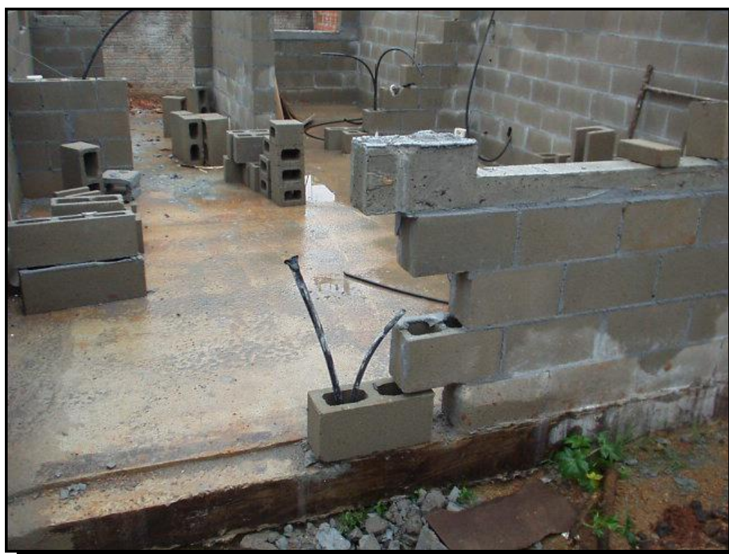
FIGURA 4.9 – Espera de eletrodutos locados em desacordo com a modulação.
