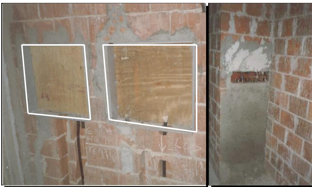
FIGURA 4.18 – Caixas de instalações elétricas e telefônicas localizadas na circulação.
