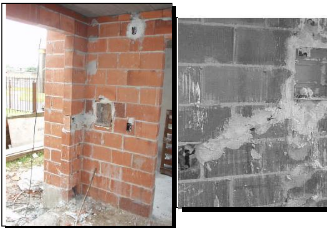
FIGURA 4.6 – Rasgos indevidos executados nas alvenarias para passagem de eletrodutos.
