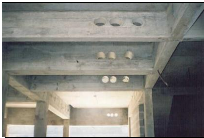
FIGURA 3.2 – Grandes furos na estrutura do primeiro pavimento.
