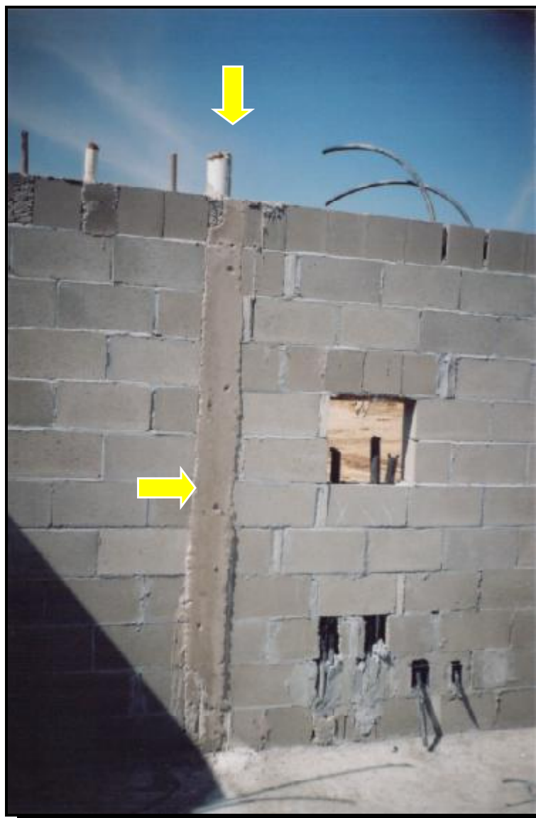
FIGURA 4.29 – Tubulação no interior da parede, aderida ao graute devido à falta de proteção.
