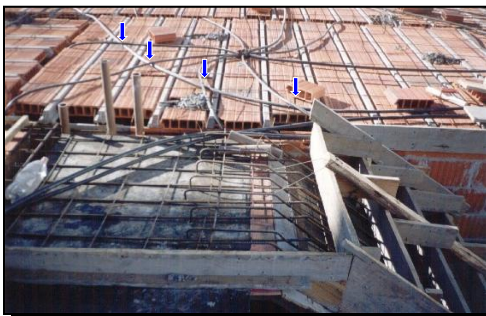
FIGURA 4.5 – Sobreposições entre eletrodutos distribuídos na laje.
