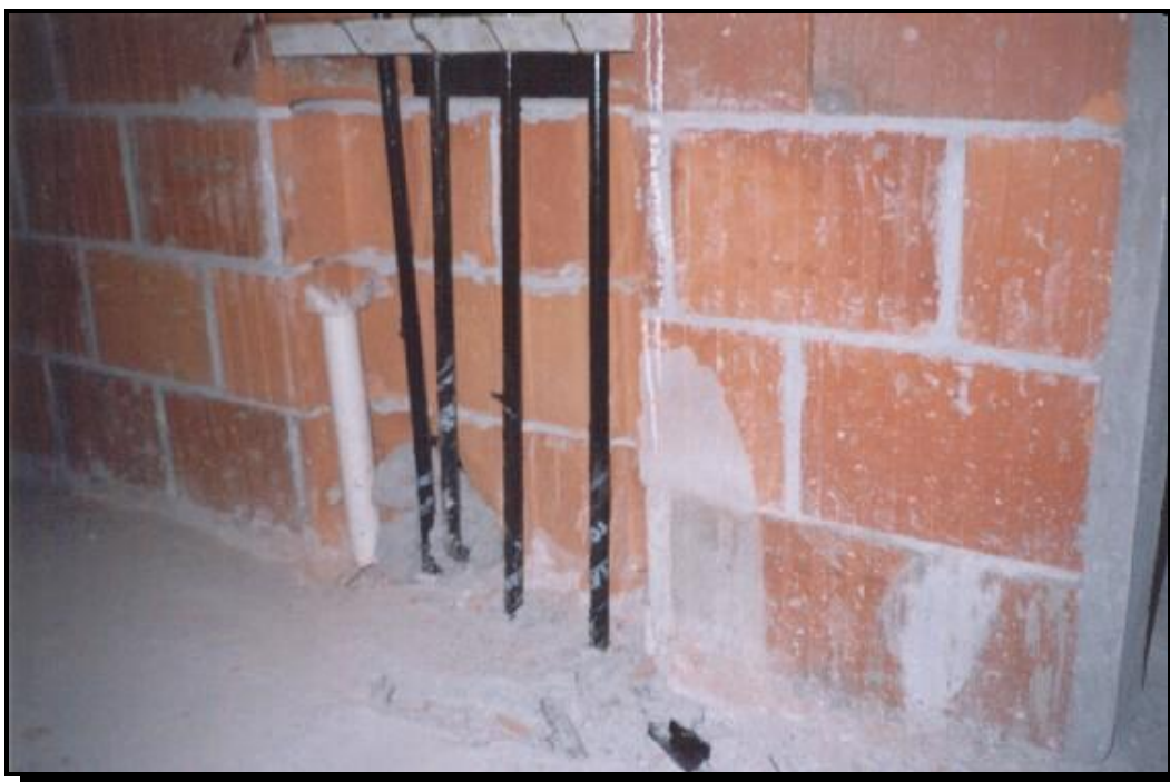
FIGURA 4.45 – Tubulação de gás através dos vazados de blocos.
