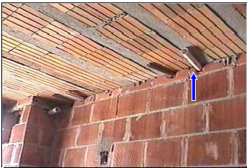
FIGURA 5.4 – Tubo de PVC “chumbado” na cinta com direção em desacordo com os demais.
