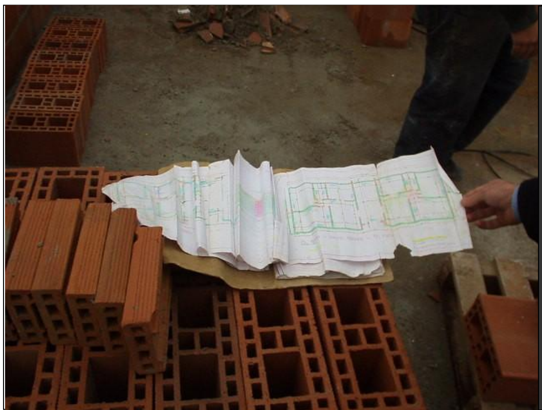
FIGURA 4.3 – Projeto em péssimo estado de conservação e apresentação, sendo utilizado na obra.
