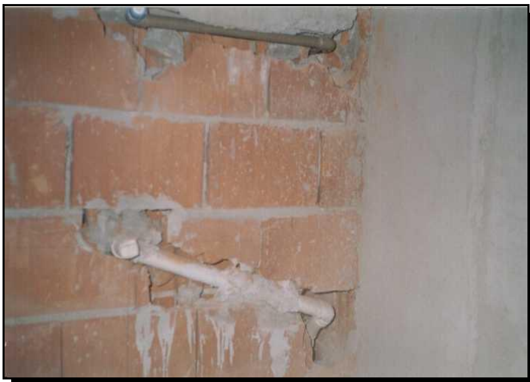
FIGURA 4.40 – Corte indevido de parede para passagem de tubulações hidrossanitárias esquecidas.
