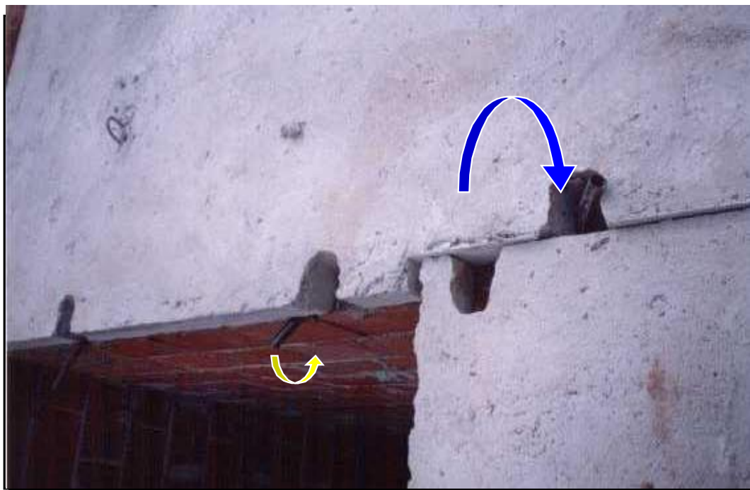
FIGURA 4.46 – Lajes maciças pré-moldadas com “dentadas” erradas.
