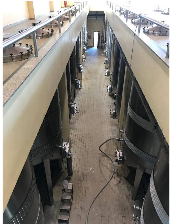
Figura 40: Tanques de fermentação, tampas com acesso pelo nível da aranha.
