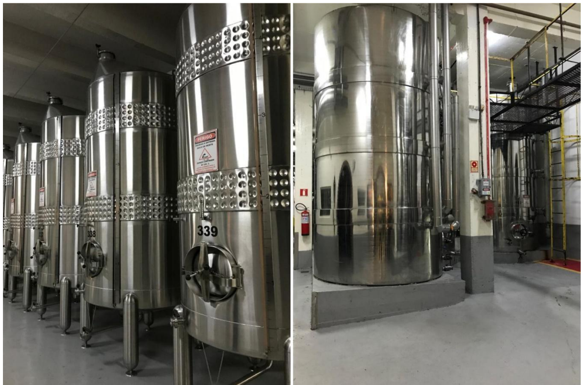
Figura 33: Tanques de armazenamento.
