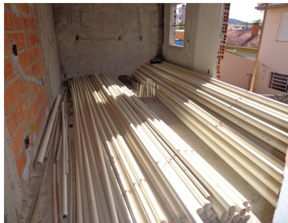
Figura 65– Organização das tubulações
