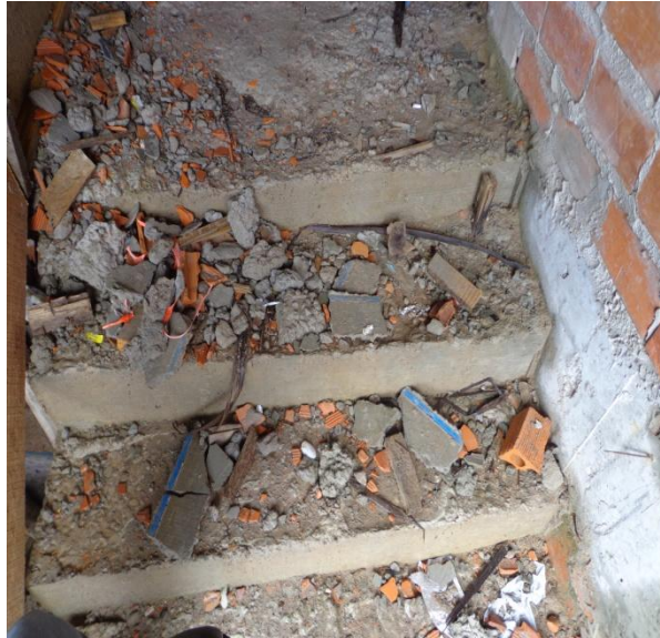
Figura 13– Entulho na escadaria
