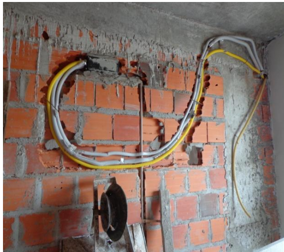
Figura 57– Muitos rasgos nas paredes
