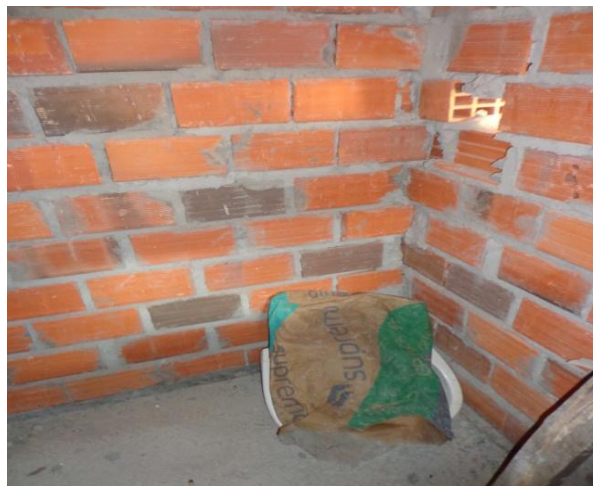
Figura 54– Lavatório por instalar
