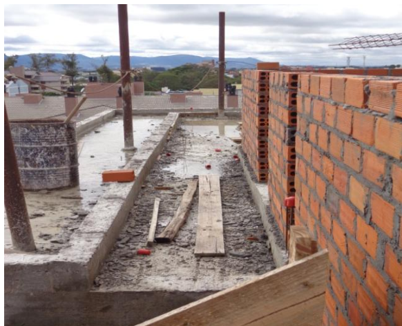
Figura 43– Protetores de vergalhão atirados
