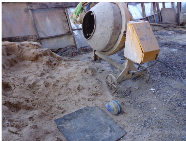
Figura 20– Central de concreto
