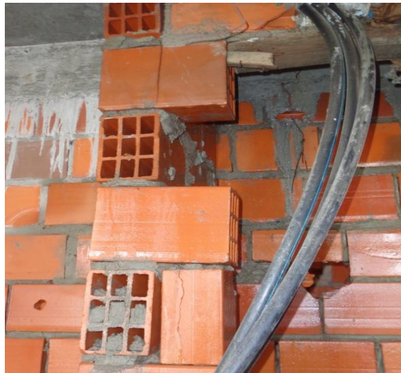
Figura 61– Trabalho mau executado
