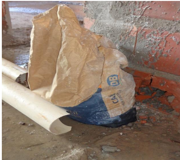
Figura 32– Saco de cimento aberto e molhado
