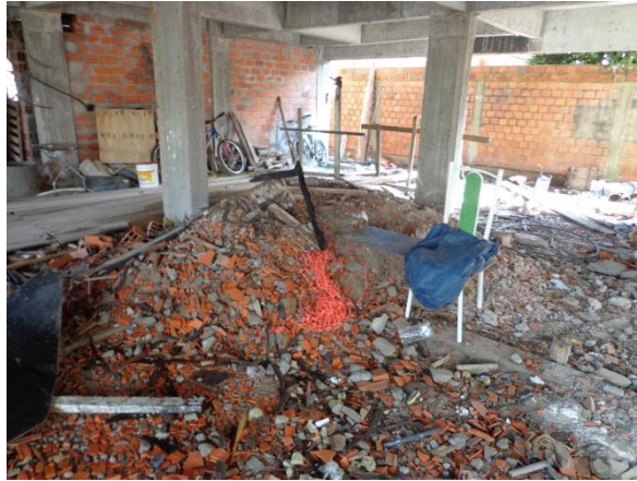
Figura 11– Movimentação dificultada pela quantidade de entulho
