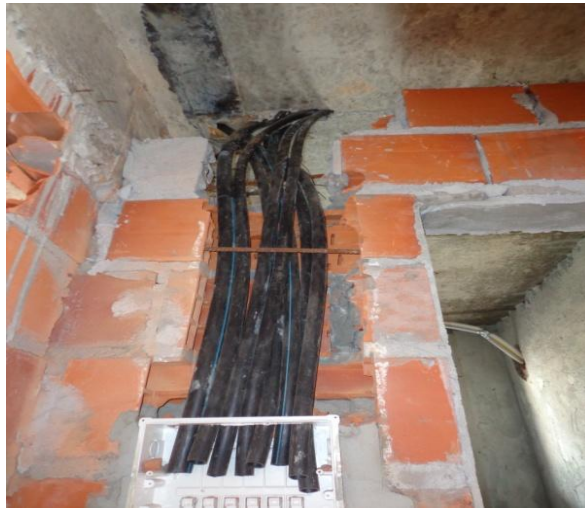
Figura 56 – Rasgos nas paredes
