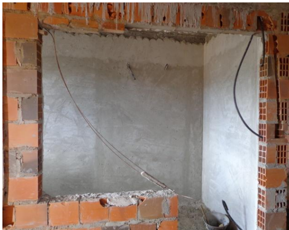
Figura 63– Problemas de execução
