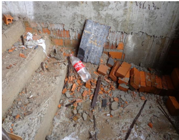
Figura 30– Sobra de uma alvenaria
