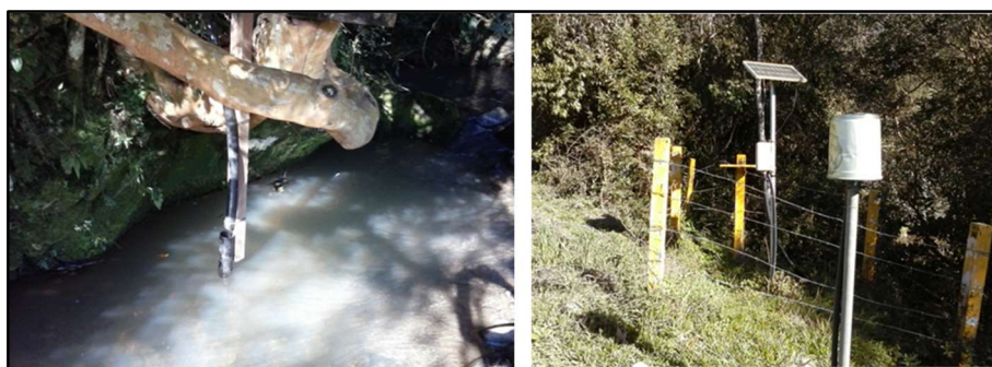
Figura 26 - Turbidímetro e estação coletora de dados instalados próximos do exutório.
