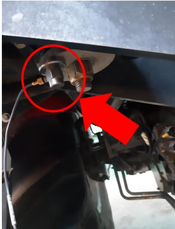
Figura 20 - Acelerômetro localizado na parte inferior do coxim
