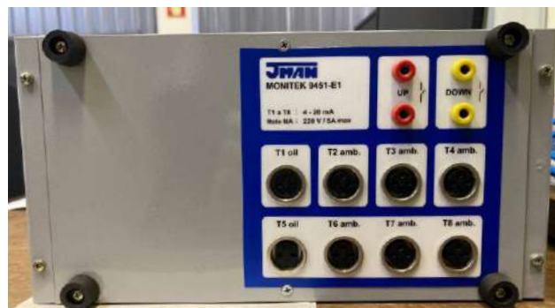
Figura 35 – Conexões elétricas para medição de temperatura e leitura dos relés do equipamento de medição JMAN MONITEK 9451.
