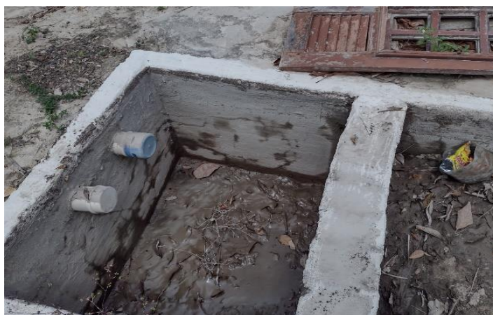
Foto 76 – Filtros para evitar a entrada de lixo orgânico e doméstico
