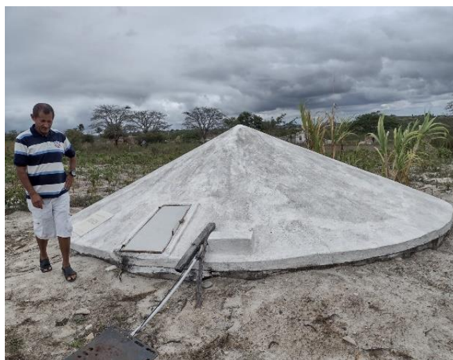
Foto 58 – Cisterna calçadão com a cobertura, a tampa e a bomba
