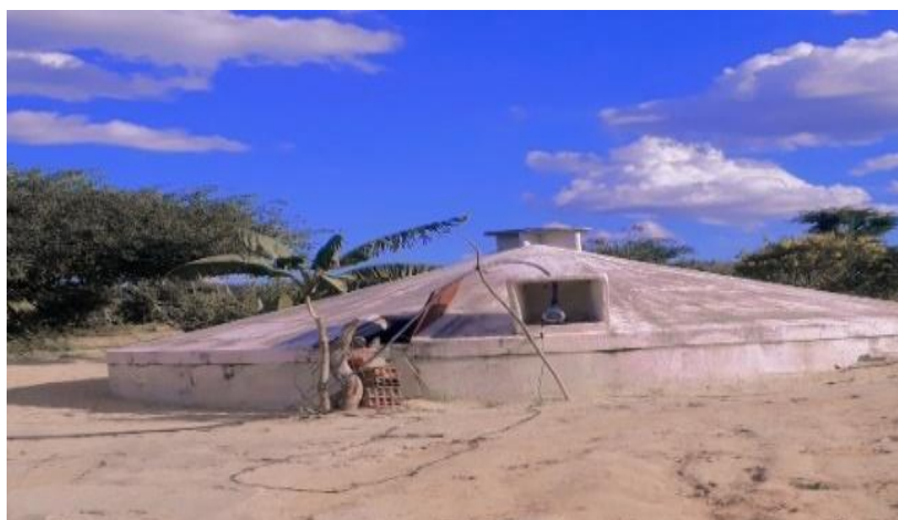
Foto 47 – Cisterna de enxurrada de D. Aparecida
