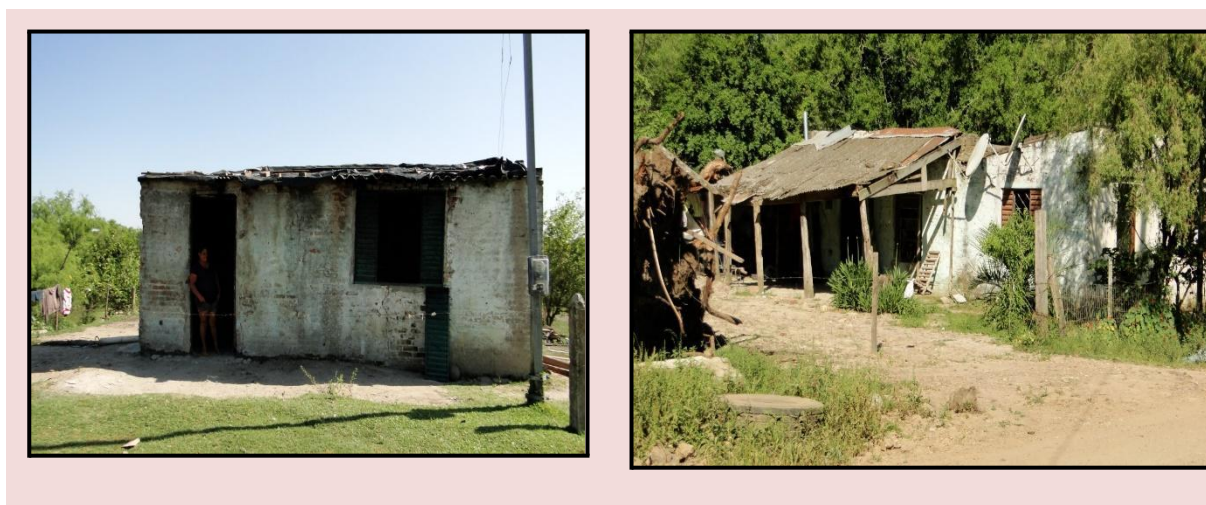
Figura 8 - Áreas de zona de inundação na pesquisa exploratória na área urbana de Dom Pedrito/RS
