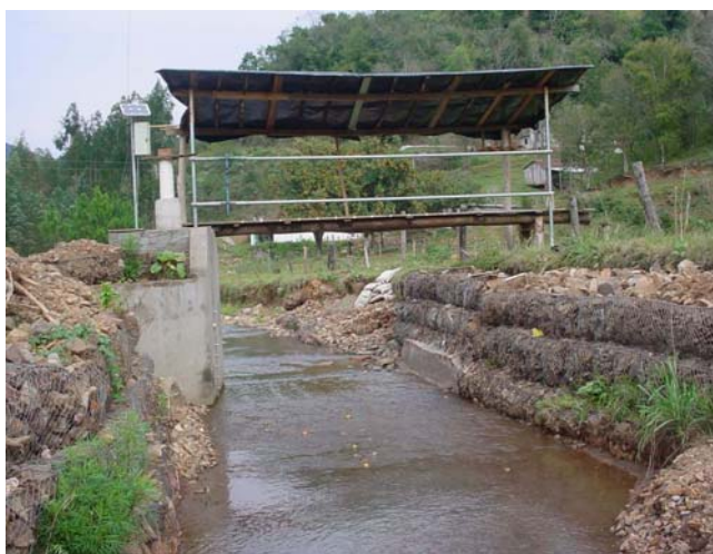
Figura 7 - Imagem da seção de controle (calha) localizada no braço principal da pequena bacia hidrográfica rural do Arroio Lino de Nova Boêmia, Agudo - RS. (Foto: Sequinatto, L.).
