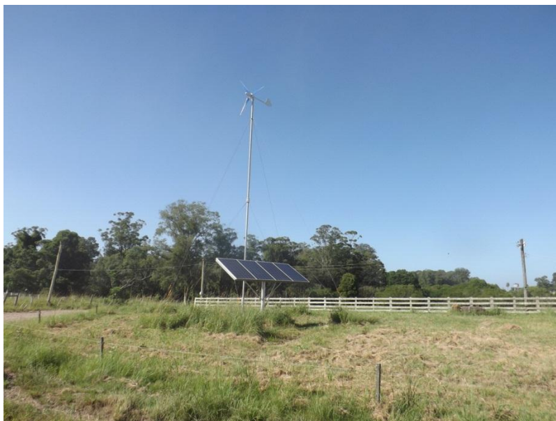
Figura 79 – Sistema Integrado de microgeração distribuída – Campus CAVG – IFSUL.
