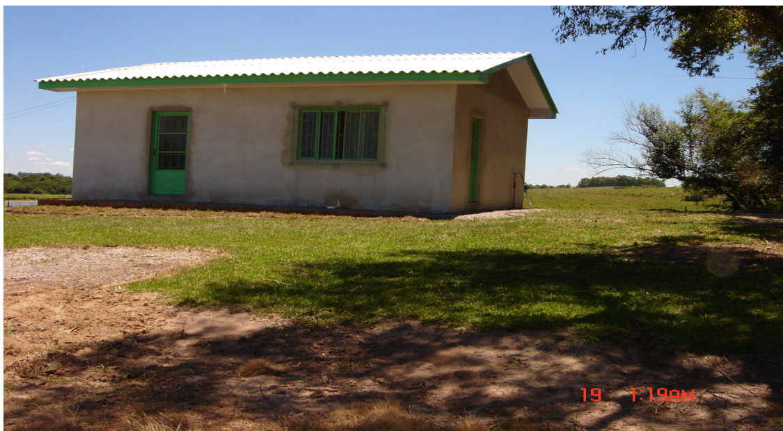
Fotografia 12: Casa em construção na propriedade dos pais de um funcionário, distrito Santa Flora, 2008.
