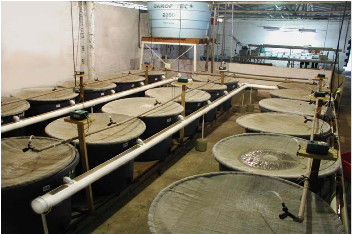
ANEXO A - Vista parcial do sistema de recirculação de água
