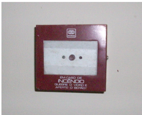
Figura 5 - Alarme de incêndio desativado
