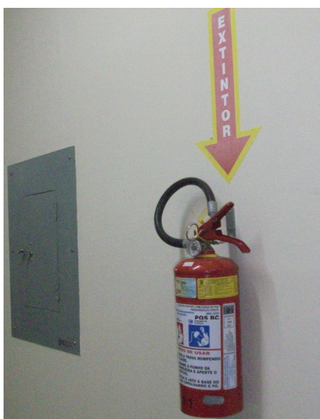
Figura 4 - Sinalização de extintor de incêndio
