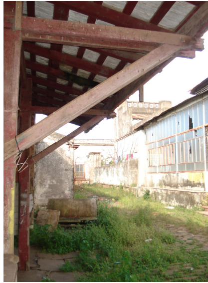
Figura 63 – Imagem atual do estado de conservação da estrutura de madeira na galeria junto a Rua das Carroças. Fonte: Arquivo pessoal, 2012.
