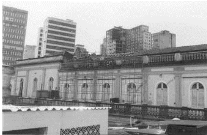
Figura 7 – Recuperação dos problemas estruturais do pavimento térreo, década de 90. Fonte: www.portoalegre.rs.gov.br/mercadopublico .
