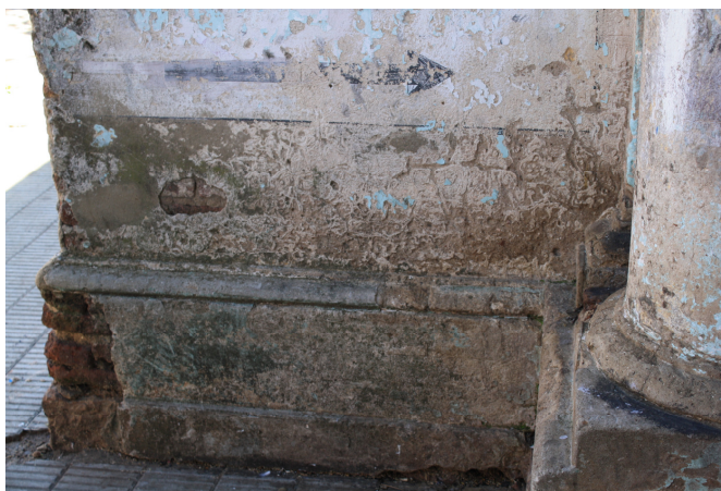
Figura 58 – Imagem atual do estado de conservação da parede externa. Fonte: Arquivo pessoal, 2011.
