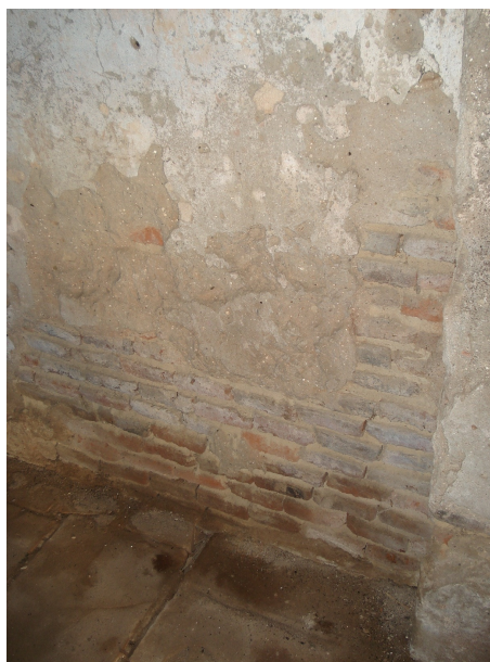
Figura 57 – Imagem atual do estado de conservação da parede interna. Fonte: Arquivo pessoal, 2011.
