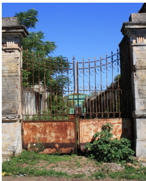
Figura 68 – Imagem atual do estado de conservação do portão lateral que dá acesso a Rua das Carroças.
