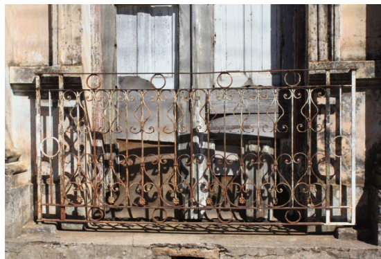
Figura 67 – Imagem atual do estado de conservação da abertura de madeira voltadas para a área externa. Fonte: Arquivo pessoal, 2012.
