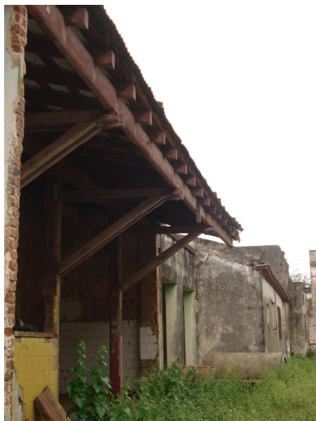
Figura 50 – Imagem da fachada interna da edificação estabelecida nos fundos do Mercado Público. Fonte: Arquivo pessoal, 2012.
