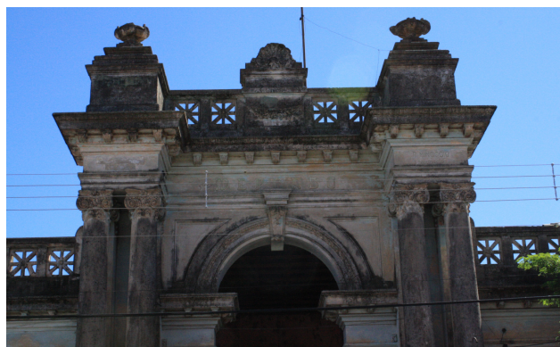
Figura 61 – Imagem atual do estado de conservação dos elementos da fachada principal. Fonte: Arquivo pessoal, 2012.
