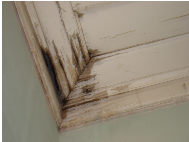
Figura 72 – Detalhe do forro de madeira com infiltrações. Fonte: Arquivo pessoal, 2011.
