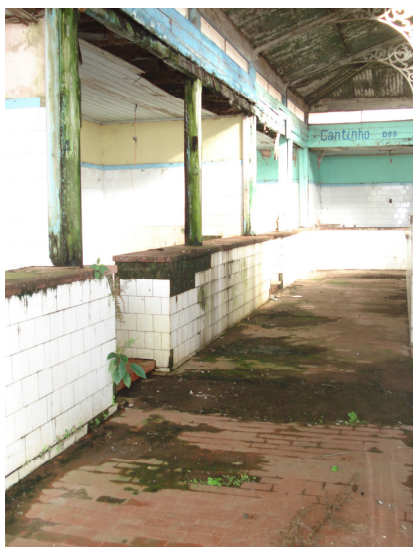
Figura 62 – Imagem atual do estado de conservação da estrutura de madeira das bancas periféricas da área central do edifício. Fonte: Arquivo pessoal, 2012.
