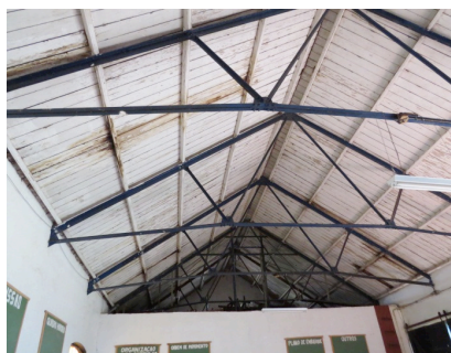
Figura 3: Detalhes da estrutura em ferro no telhado, utilizada em todas as edificações. Fonte: Acervo do autor, 2015.
