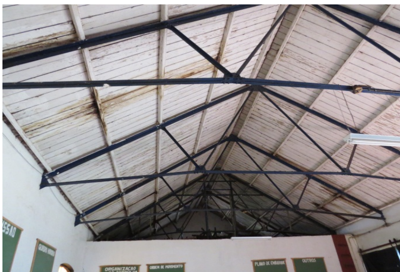
Figura 98 - Detalhes da estrutura em ferro no telhado, utilizada em todas as edificações
