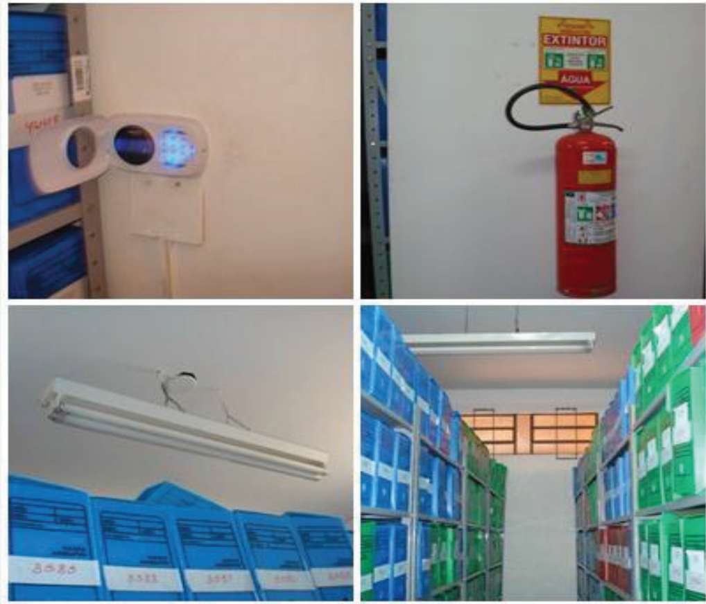
Figura 8: prevenção contra roubos, furtos e incêndio, porém, sem climatização e controle de temperatura e umidade (Autoria: Jair Carlos Hüttinger, out. 2014).
