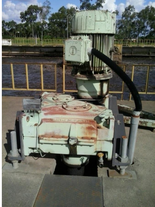
Figura 21 - Motor do Aerador da Estação de Tratamento de Esgoto de Santa Maria – RS
