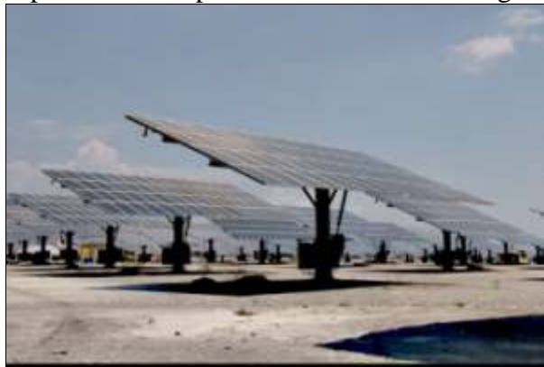
Figura 07: Vista dos painéis da cooperativa La Jeresa com seguidor solar de 2 eixos.
