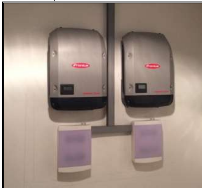
Figura 11: Instalação fotovoltaica com inversores multistring .
