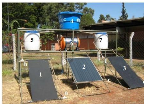
Figura 17 - Coletores Solar e reservatórios Fonte: Siqueira (2009)
