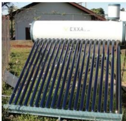
Figura 10 - Coletor solar com tubos a vácuo tipo all-glass instalado na UNIOESTE Fonte: Neves (2013)
